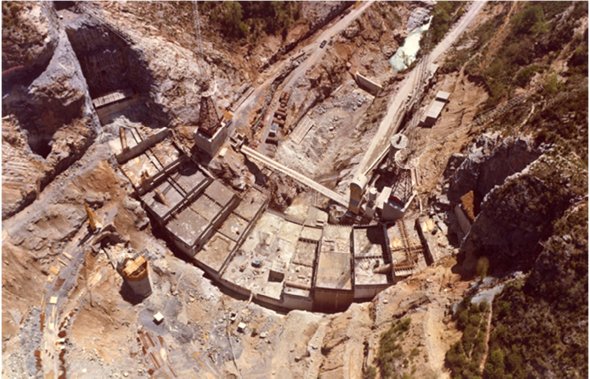
Figura 23: Vista general de la excavación y arranque de los bloques de la presa de Quéntar (Fuente: ref.[17])
