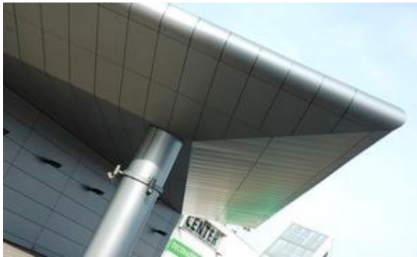
Ejemplo de revestimiento inferior con sistema alucobond
