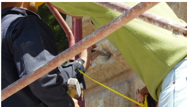
Fig.11 Misura della profondità della lesione.
