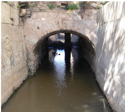
Figura 84. Salida del cárcavo. Molí de Farinós. Autor Propio 2015
