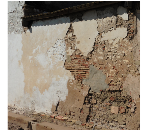
Figura 130. Muro de Tapial Calicastro. Perímetro este del patio de la alquería. Autor Propio 2015
