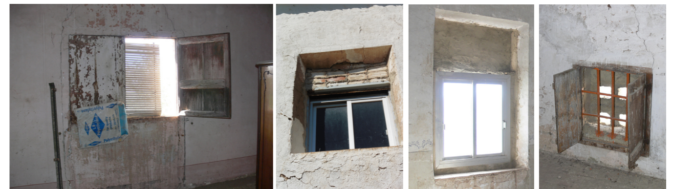
Figuras 158 - 161. Diferentes tipos de ventana y cerrajería en planta alta del edificio. Autor Propio 2015
