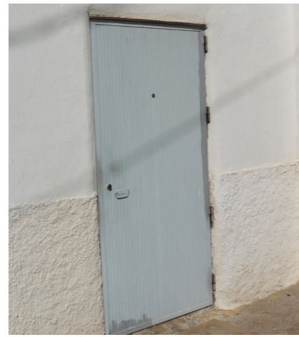
Figura 163. Puerta metálica de acceso en anexo al molino. Autor Propio 2015
