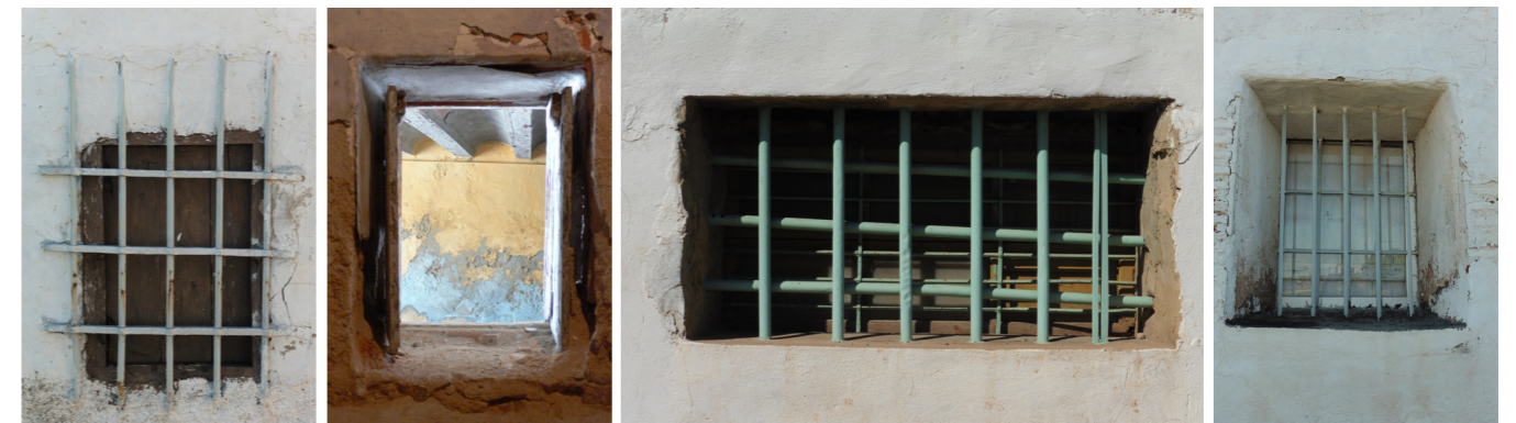
Figuras 154 - 157. Diferentes tipos de ventana y cerrajería en planta baja del edificio. Autor Propio 2015
