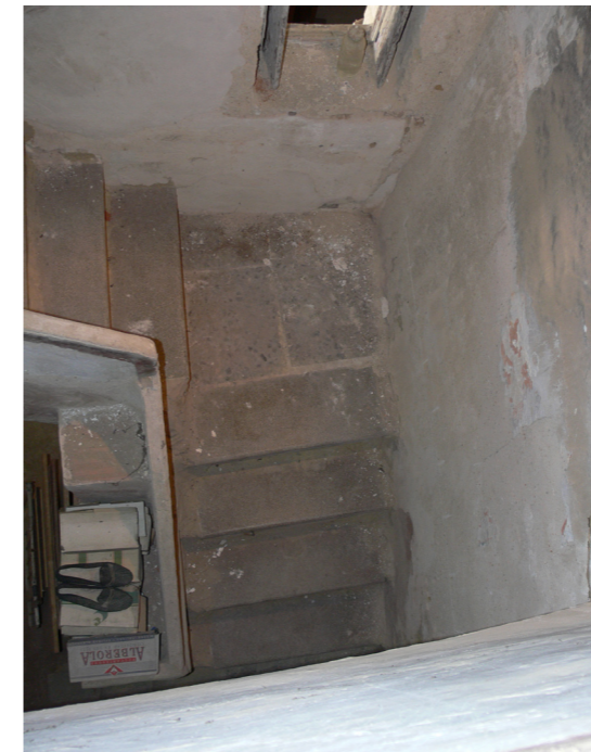
Figura 169. Escalera de bóveda tabicada para acceso a primera planta de la alquería. Autor Propio 2015
