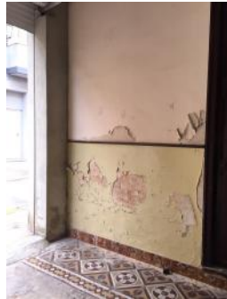
Figura 50. Humedad capilar en la pared del pasillo. 2016. In Situ.
