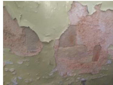
Figura 51. Humedad capilar en la pared del pasillo. 2016. In Situ.
