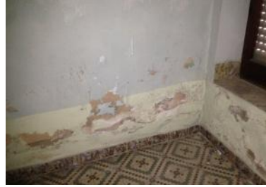
Figura 49. Humedad capilar en la pared de la habitación. 2016. In Situ.
