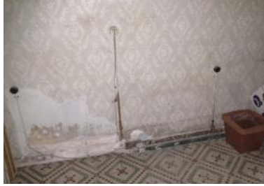
Figura 48. Humedad capilar en la pared de la habitación. 2016. In Situ.
