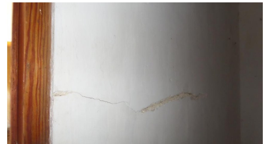
Ilustración 62. Detalle de la lesión (Fuente propia)
