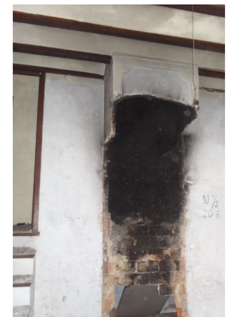
Ilustración 68. Chimenea afectada por el vandalismo (Fuente propia)
