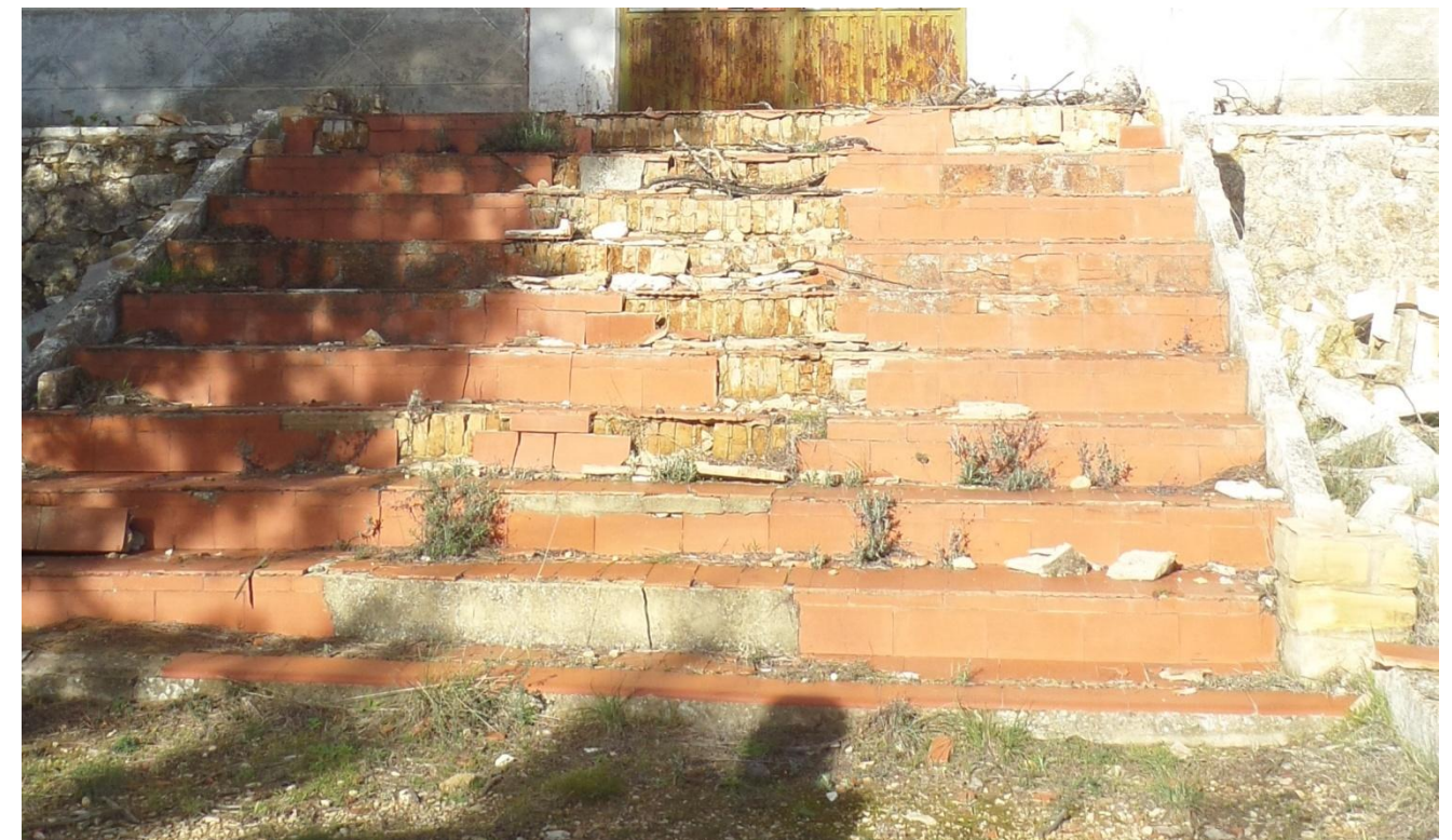
Ilustración 55. Detalle del desprendimiento del revestimiento de la escalera (Fuente propia)
