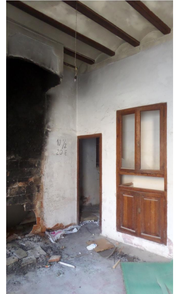
Ilustración 19. Detalle de chimenea rota en habitación (Fuente propia)
