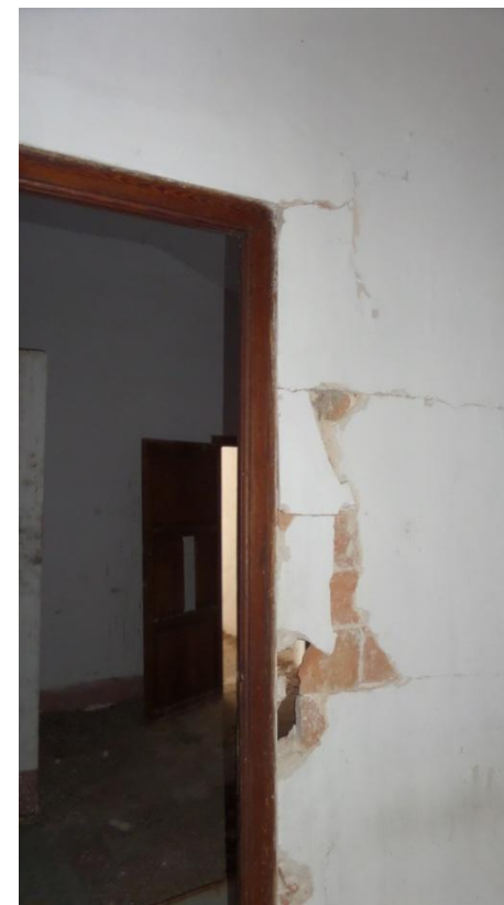
Ilustración 61. Detalle de la lesión (Fuente propia)
