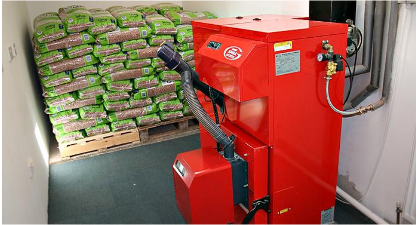
Ilustración 88. Caldera de biomasa. 2014. Ecologismos
