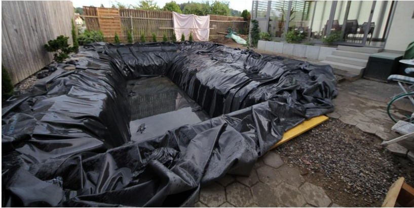
Ilustración 105. Lámina impermeabilizante. 2015. Davidwolfe
