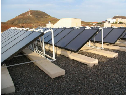
Ilustración 63. Soportes de paneles solares térmicos. 2014. Lampisteriamansalas
