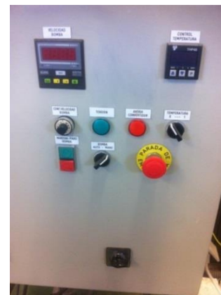
Figura 26. Cuadro de control.
