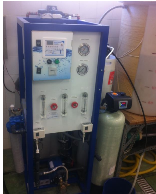
Figura 41. Planta de agua osmotizada (DIQN-UPV).
