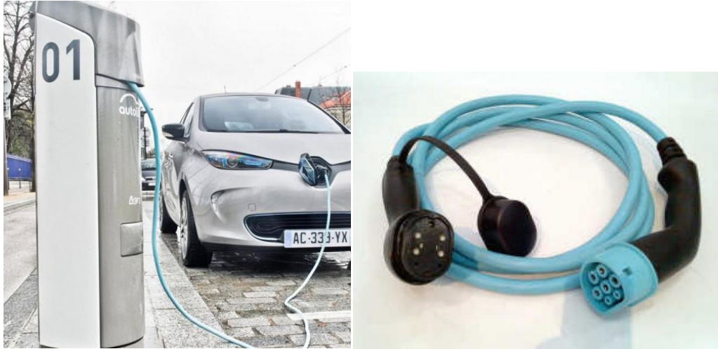
ILUSTRACIÓN 35: ELECTROLINERA Y CABLES DE ALIMENTACIÓN
