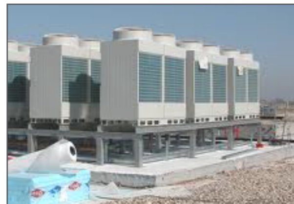
Condensadoras Equipos exteriores en Cubierta
