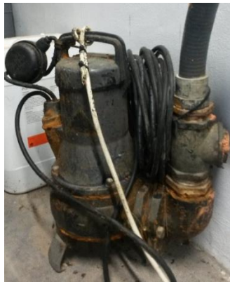
Figura N° 18: Bomba instalada en el depósito de almacenamiento (6m 3 /h).
