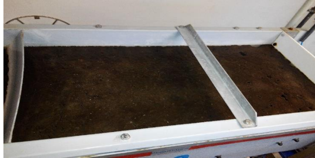
Figura N° 11: Fangos flotantes en el decantador lamelar del proceso Físico-químico.
