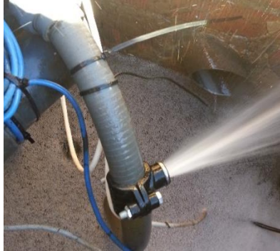
Figura Nº 19: Caudal de retorno del sistema de bombeo
