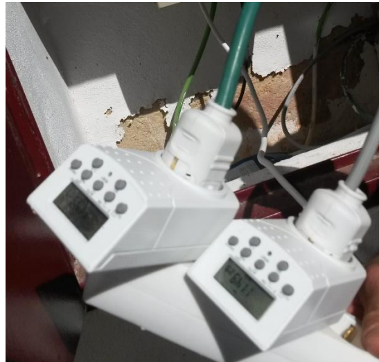
Figura N° 30: Temporizadores para controlar los tiempos de recirculación.
