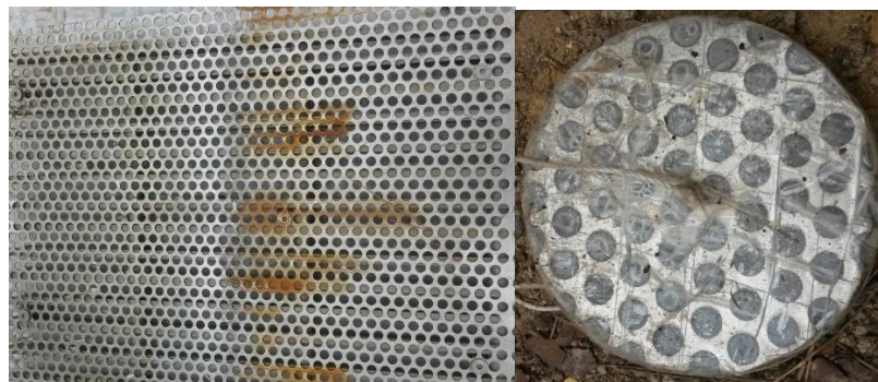
Figura N° 5: Geometría y abertura del sistema de rejas instaladas inicialmente.
