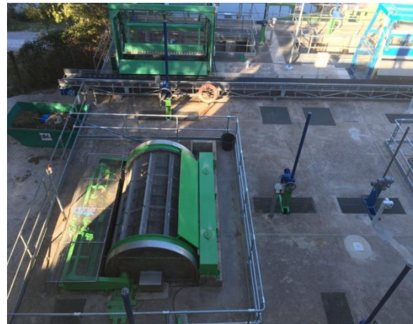
Figura 40. Pre-tratamiento La Presa.
