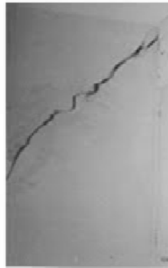
Figura 9.- Grietas en fachada vistas desde el interior
