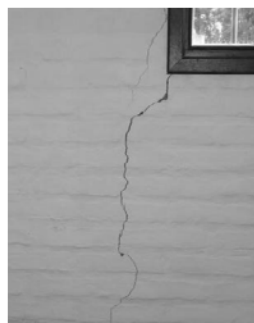
Figura 4.- Grietas en esquina inferior ventana
