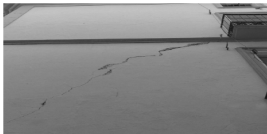
Figura 2.- Grietas en fachada por asientos en zona central
