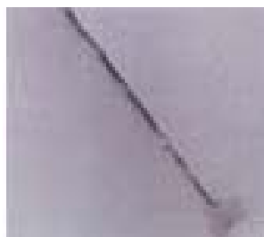
Figura 7.- Despegue entre viga y tabique
