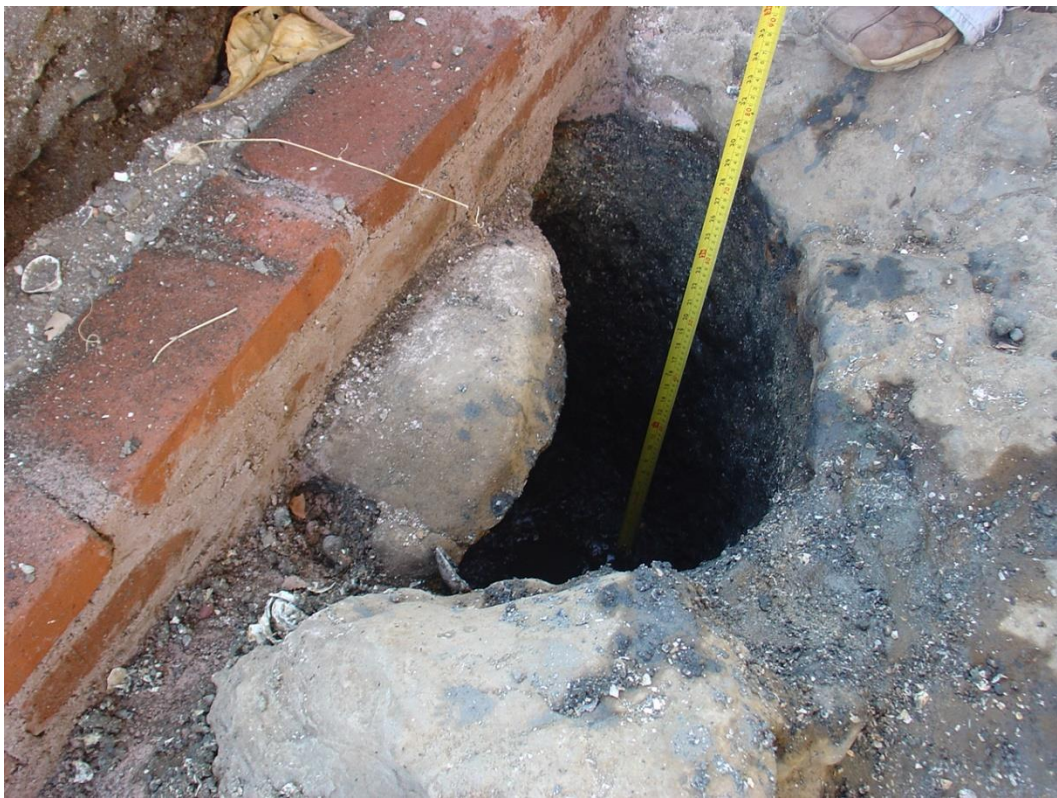
Imagen 4.36: orificios encontrados cercanos a los muros (PPV).
