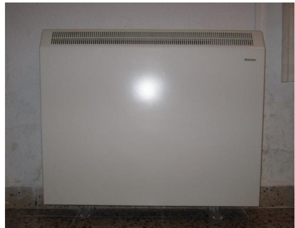
20 Instalación de calefacción. Fuente: Sara Monteagudo.
