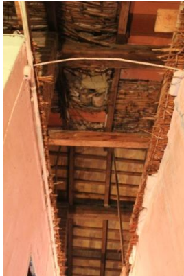
Figura 49. Falso techo derruido planta primera. 2016. Propia.
