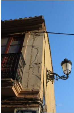
Figura68. Antigua disposición cableado eléctrico. Año. Propia.
