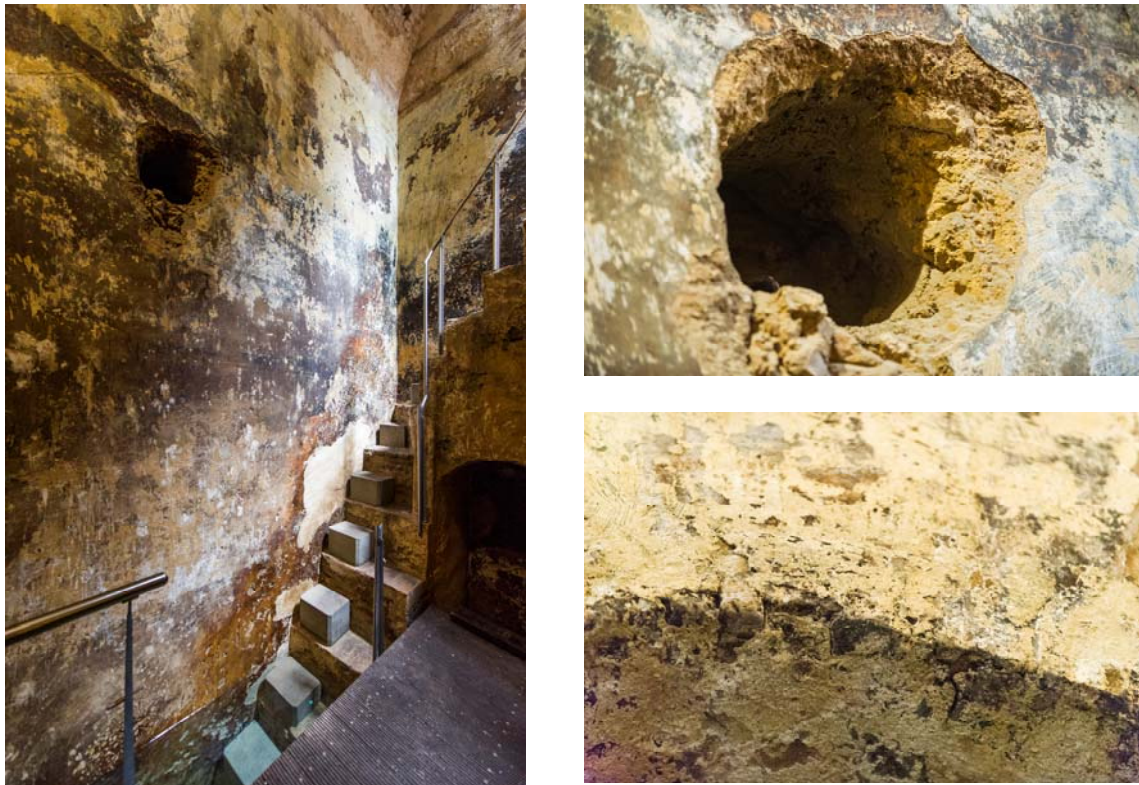
Figura 8. Izquierda, vista escalera acceso y peana flotante. Derecha, detalle lesión muro y ladrillo cerámico de arquería.2016. Edu Francés
