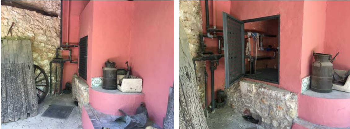
Figura 1. Cobertizo exterior donde se sitúan las instalaciones de extracción de agua que se ven en la bóveda de la nave 1 de acceso. 2016. Autor
