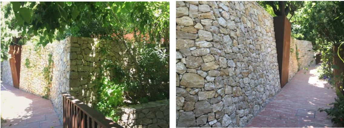
Figura 4. Muro de mampuestos que contiene y forma la terraza exterior al perímetro del aljibe.2016. Autor
