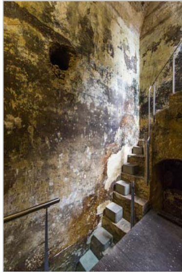
Figura 1. Vista general de la lesión en el muro
