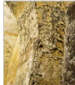
Figura 3. Pérdida de material de revestimiento en muro nave 1
