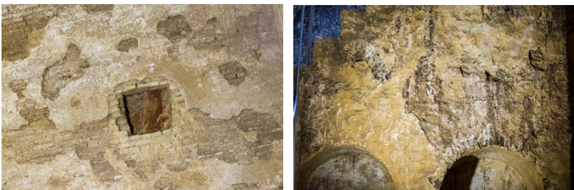
Figura 7. Izquierda, detalle orificio original extracción aguas. Derecha, lesión en escalera acceso. 2016. Edu Francés
