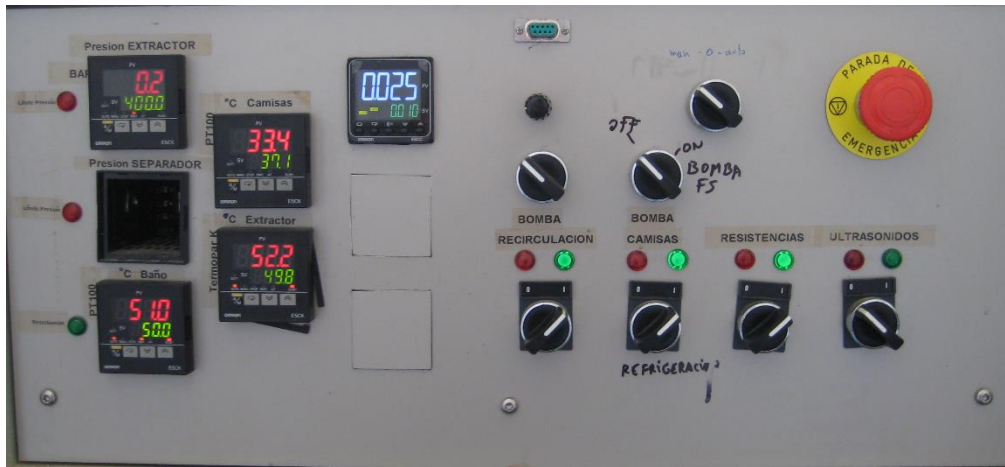
Fig.4.2. Montaje de los controladores e interruptores de la instalación. 1- unidad 00 (presión en el extractor); 2- unidad 02 (temperatura del baño termostático); 3- unidad 03 (temperatura de las camisas de la bomba de jeringa); 4- unidad 04 (temperatura en el extractor); 5- unidad 05 (caudal másico de CO 2 ).
