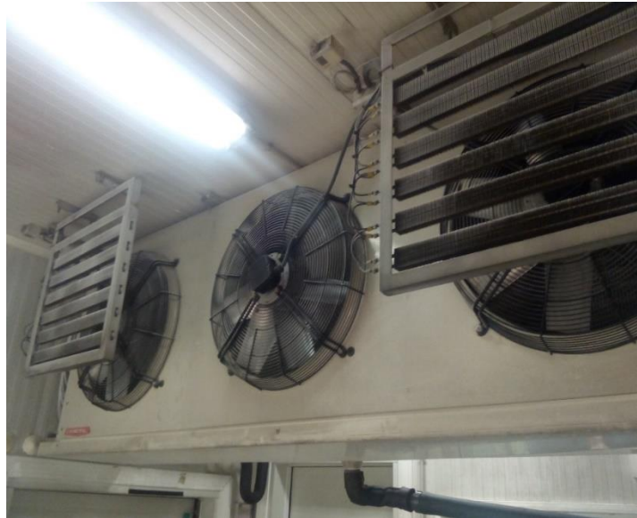
Figura 3.13 Máquina de frío encargada de refrigerar la celda de ensayos
