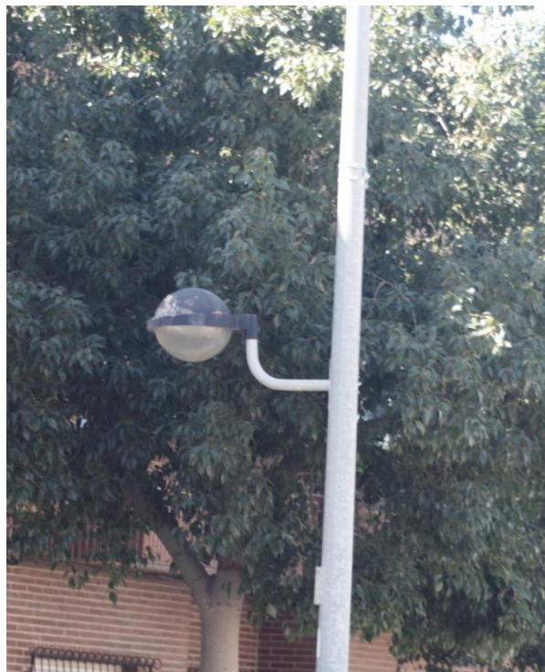
Detalle luminaria ambiental entre arbolado
