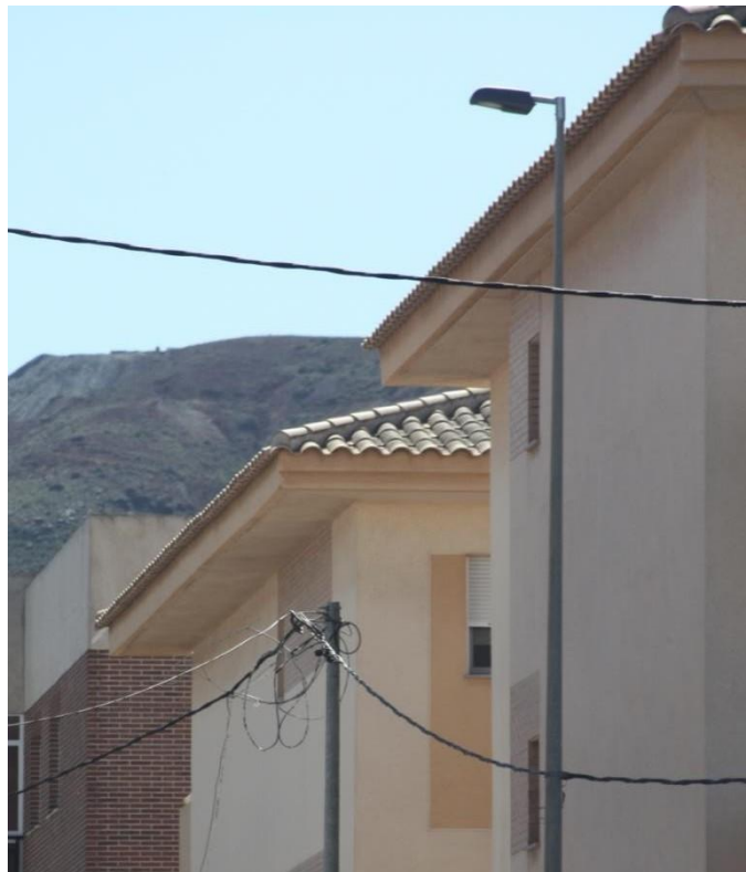
Detalle luminaria soporte columna
