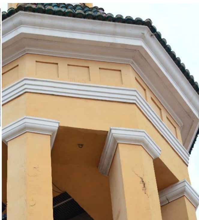
Figura 107: Grietas en el campanario. Fuentes propias
