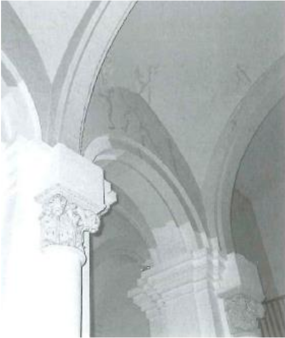
Figura 23: Grietas en las bóvedas. Parroquia de San Roque Benicalap-Valencia. Primer Centenario (1902-2002).
