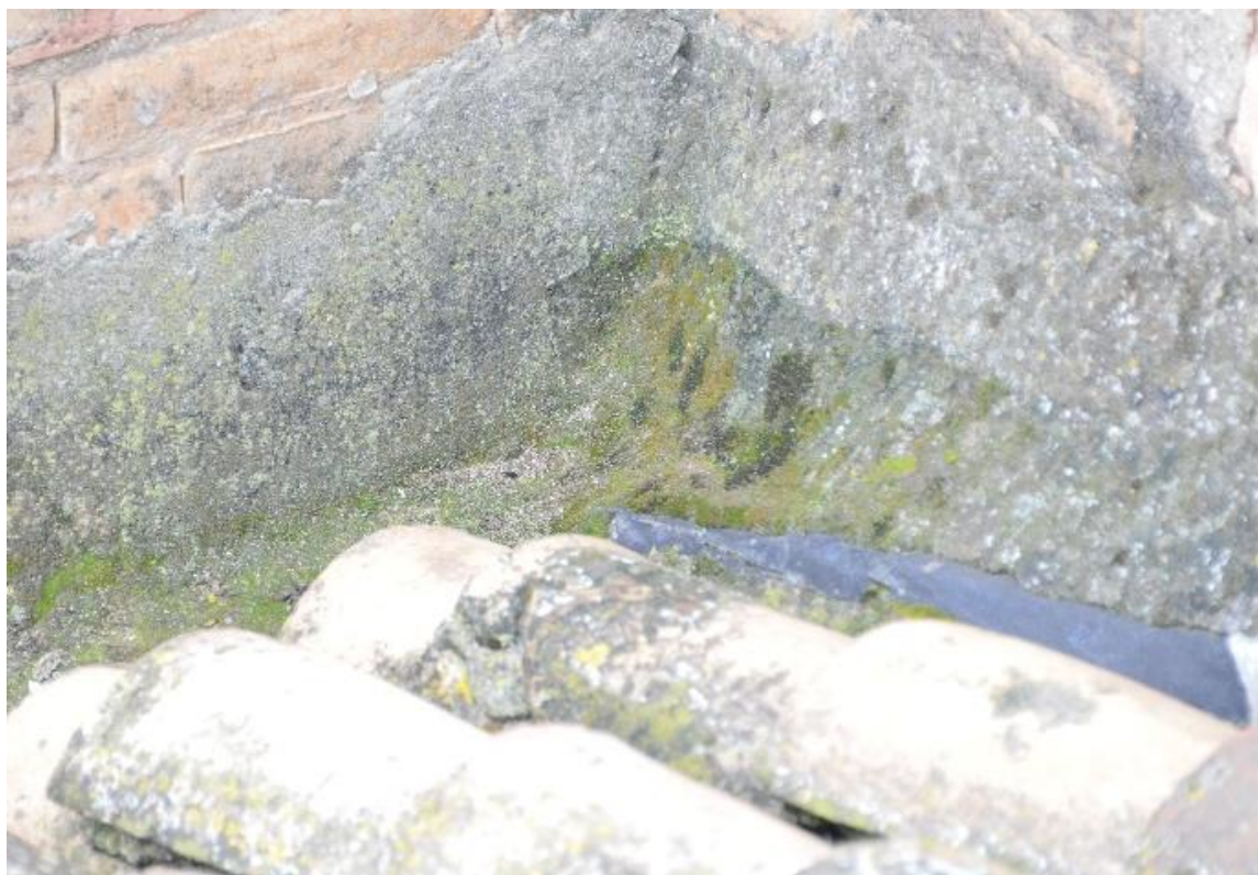
Figura 60: Algas y musgo: Cubierta del Templo. Fuentes propias.
