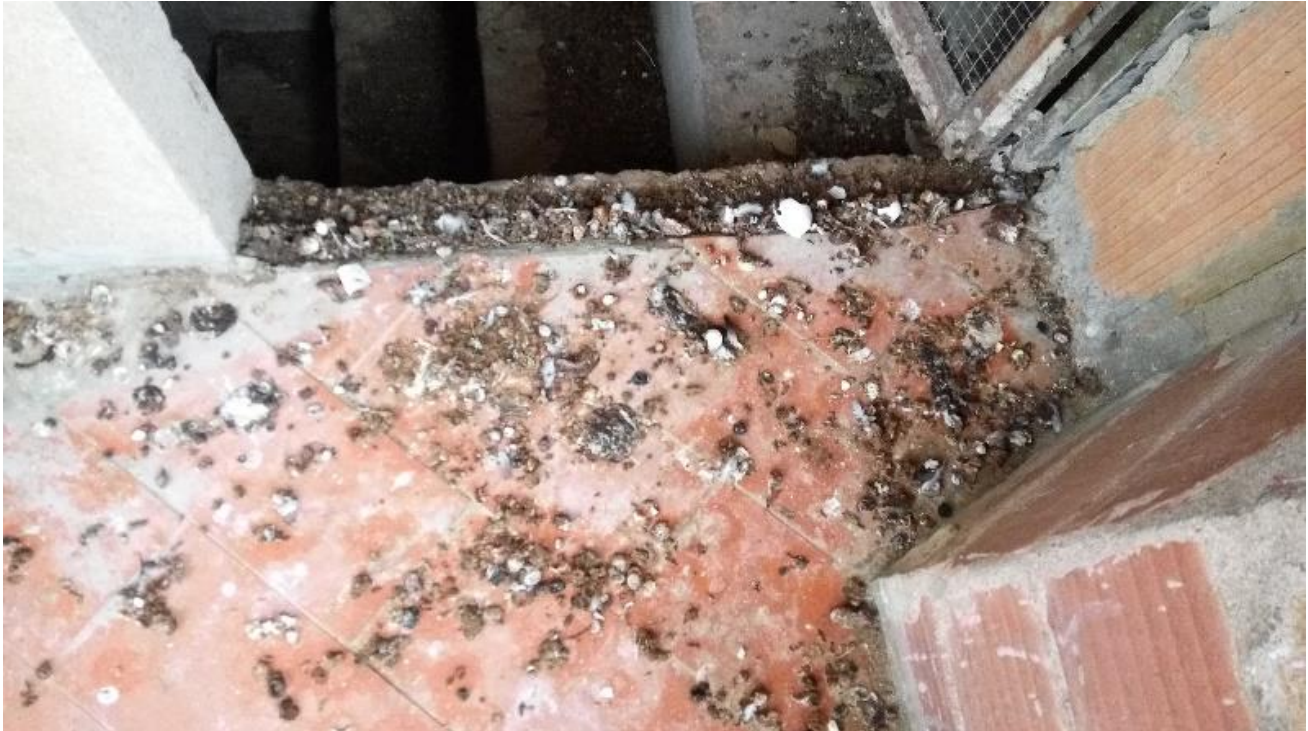
Figura 61: Excrementos de paloma. Torre campanario. Fuentes propias.
