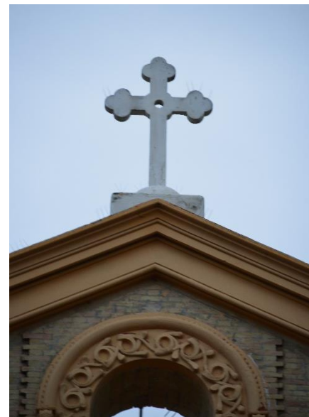
Figura 97. Cruz de piedra fachada principal. Fuentes propias
