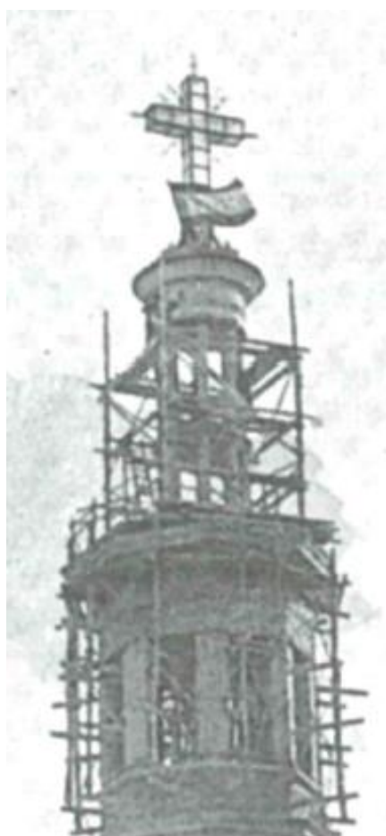
Figura 13: Proceso de ejecución del campanario. Parroquia de San Roque Benicalap-Valencia. Primer Centenario (1902-2002).
