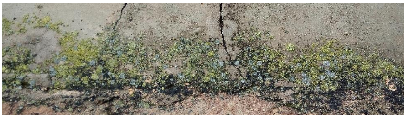
Figura 59: Líquenes. Cubierta del Templo. Fuentes Propias.
