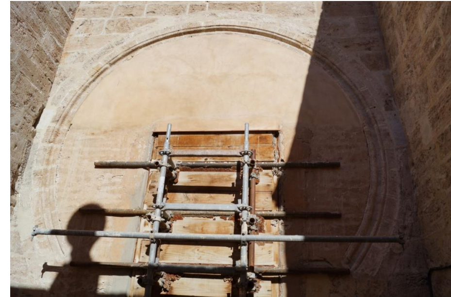
Fig. 30. Primitivo rosetón, hoy cegado, sobre la antigua puerta de la calle del Peso de la Paja.
