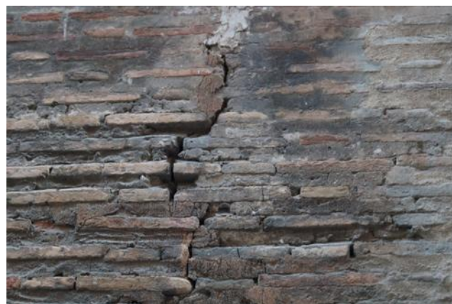
Fig. 52. Fotografía Fisura fachada Capilla de la Comunión. Fuente: (propia)
