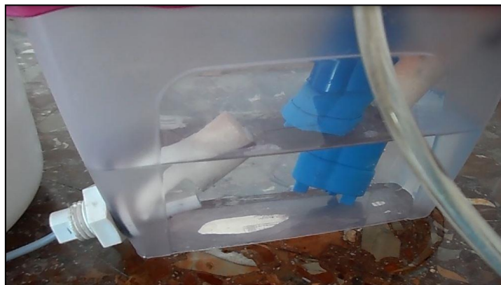
Ilustración 59. Nivel mínimo depósito 58
