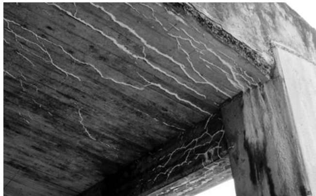
Figura 4. Trazos blancos de carbonato cálcico en las fisuras, [2].
