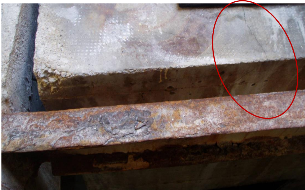
Figura 120. Fisuración de las bases de hormigón.
