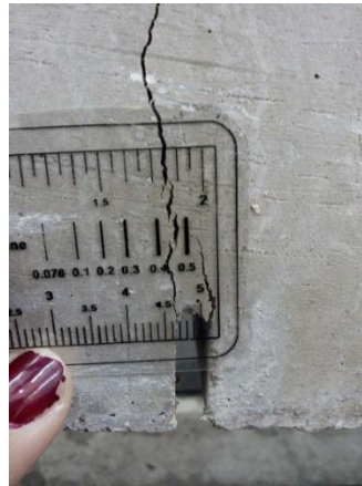
Figura 77. Comparación de la abertura de fisura con un fisurómetro. Fisura final deseada de 0,3 mm.
