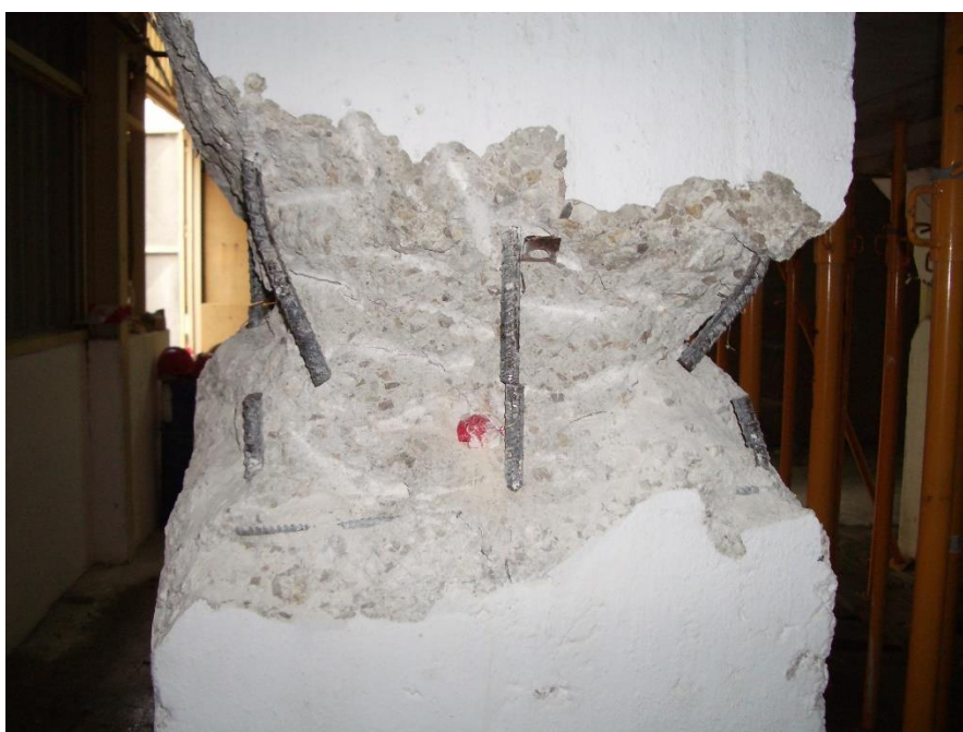
Figura 122. Patología de uno de los pilares que sujeta la losa en la que apoya la turbina.
