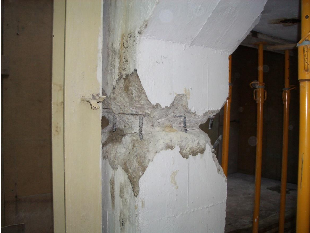
Figura 123. Patología de uno de los pilares que sujeta la losa sobre la que apoya la turbina.
