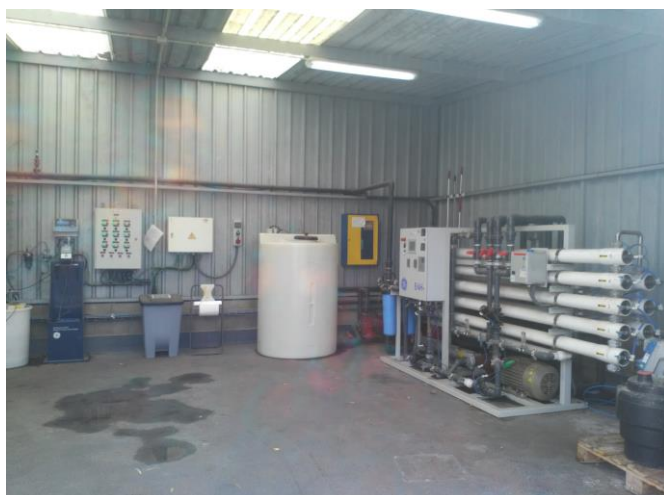
Imagen 41. Planta de Osmosis inversa
