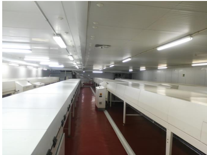
Imagen 37. Túneles de atemperado
