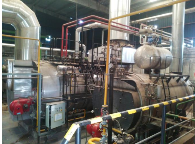
Imagen 39. Calderas de vapor
