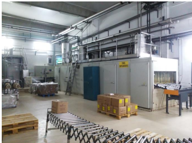
Imagen 24. Túnel de Atemperado de Manteca
