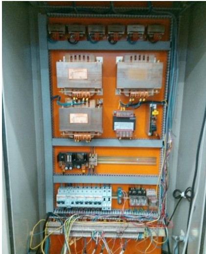
IMATGE 3.7 INTERIOR ARMARI CONNEXIONAT
