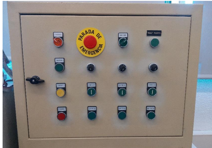
IMATGE 3.8 EXTERIOR ARMARI CONNEXIONAT
