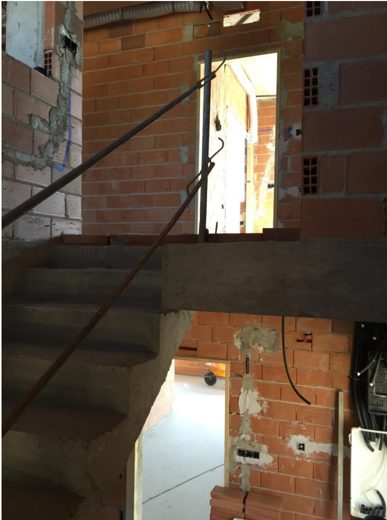
1.28 Poca seguridad en la escalera.
