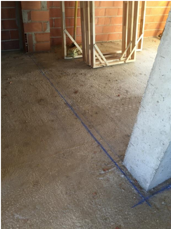
1.19 Proceso de replanteo tabiquería interior y acopio de los premarcos de las puertas interiores.
