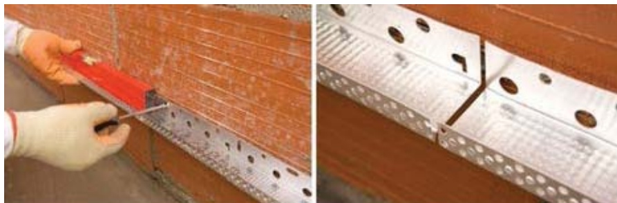
Ilustración 5-2. Arranque del sistema. Fuente: www.weber.es
