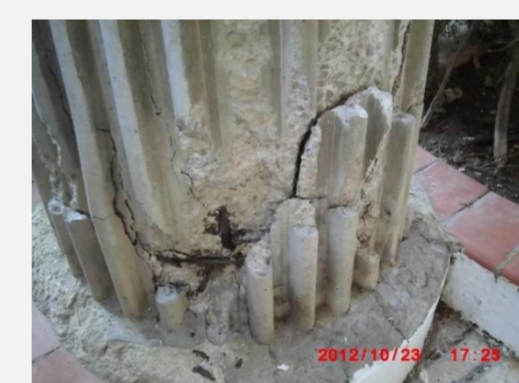
3. Pilar en planta baja afectado por la humedad del riego y de las lluvias por azote lateral
