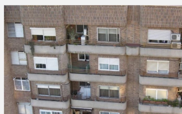
1. Carbonatación del hormigón en zunchos de forjado y jardineras de hormigón.
