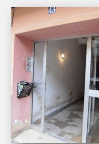
11. Humedades por capilaridad en zaguán debida a fuga en saneamiento.
