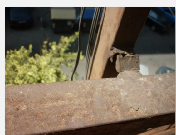
5. Corrosión de barandillas, pérdida de sección y rotura por ausencia de junta de dilatación.
