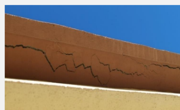
2. Corrosión de armaduras en zunchos de forjado.
