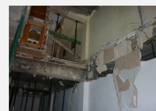
4. Colapso frágil de forjado.
