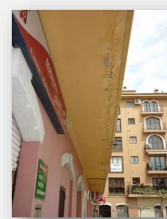
9. Deficiencia impermeabilización de balcón
