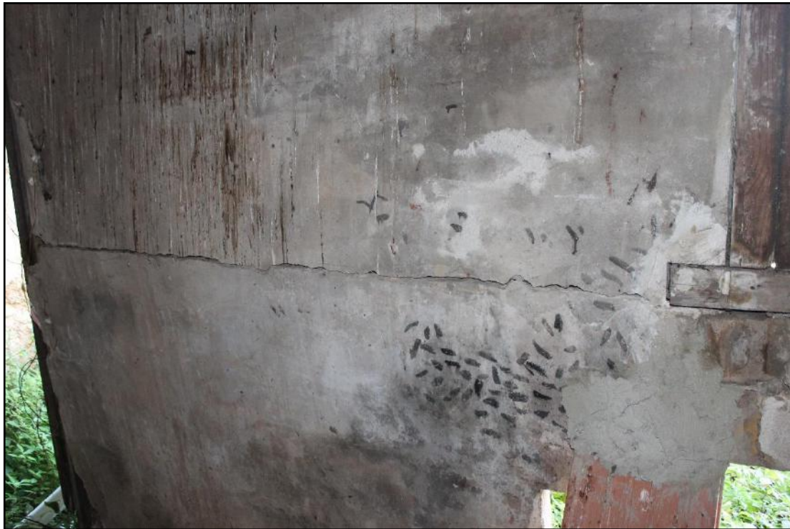
Ilustración 105 Grieta horizontal Fuente: Propia
