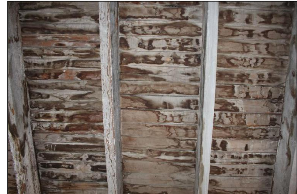
Ilustración 115 Humedad en tablero Fuente: Propia
