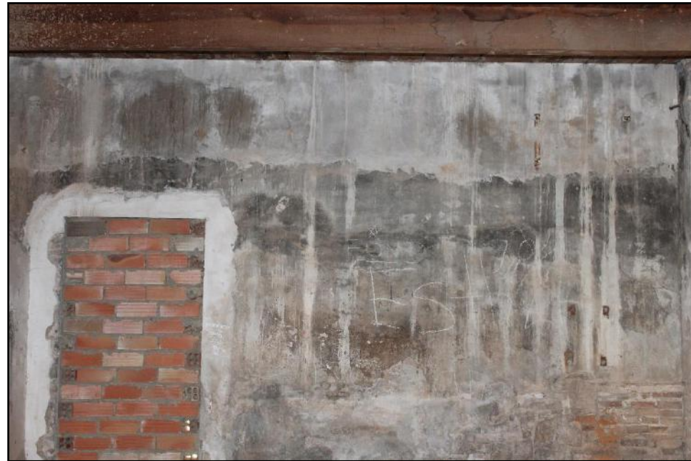
Ilustración 101 Suciedad y humedad Fuente: Propia
