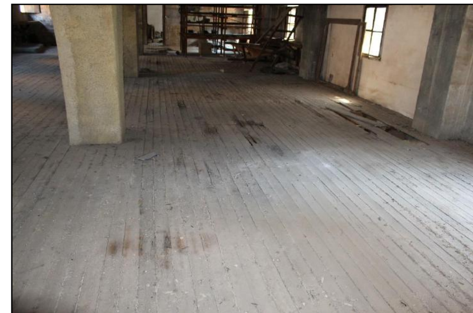
Ilustración 113 HUMedad y falta de listones en forjado P.1ª Fuente: Propia
