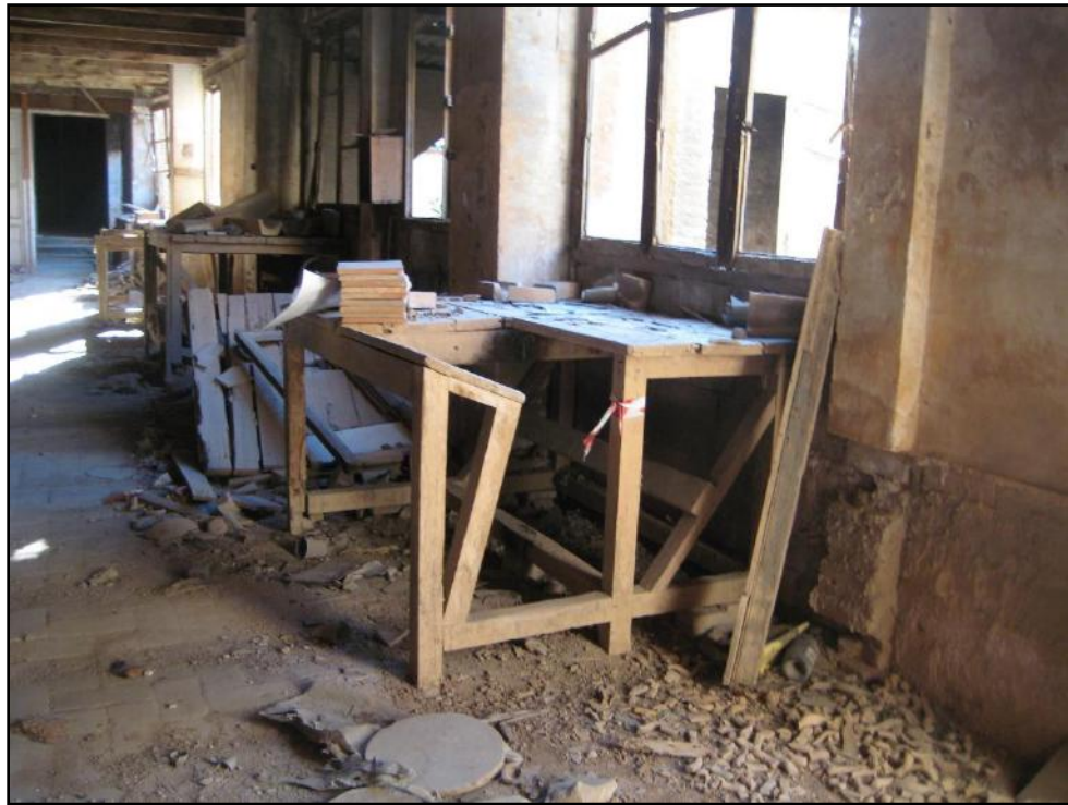
Ilustración 108 DESconchados fachada Noroeste Fuente: Propia
