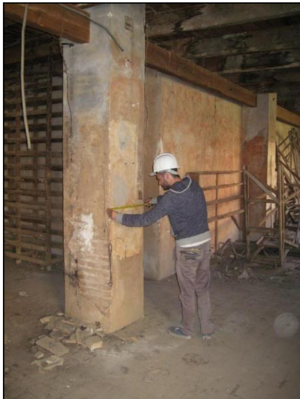
Ilustración 73 Pilar Fuente: Propia
