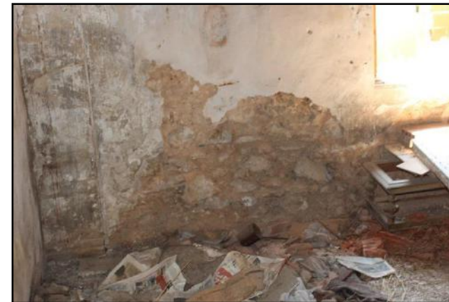
Ilustración 85 Desconchado de revestimiento Fuente: Propia
