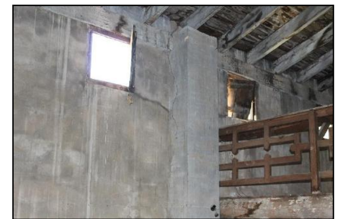
Ilustración 86 Grieta ventana, escorrentía Fuente: Propia
