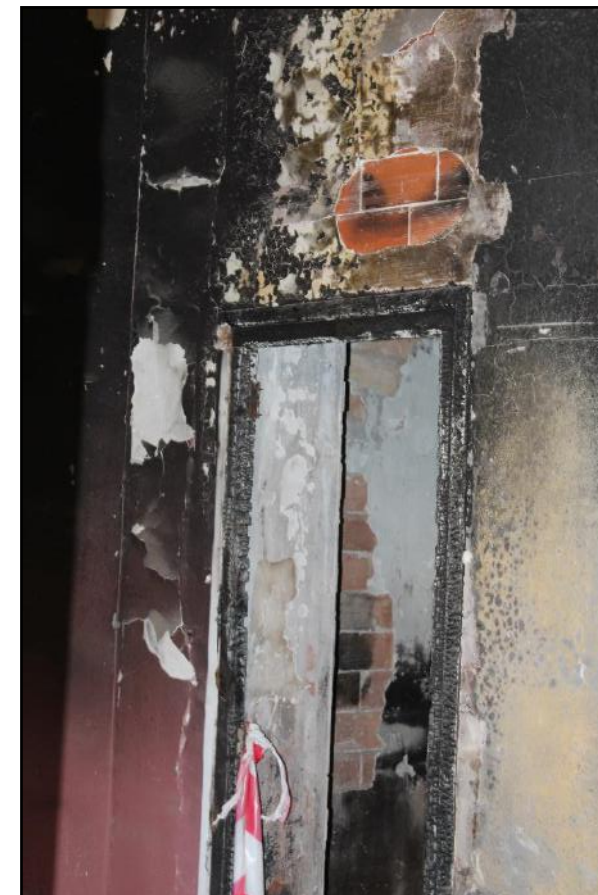
Ilustración 55 Marco quemado vivienda Fuente: Propia
