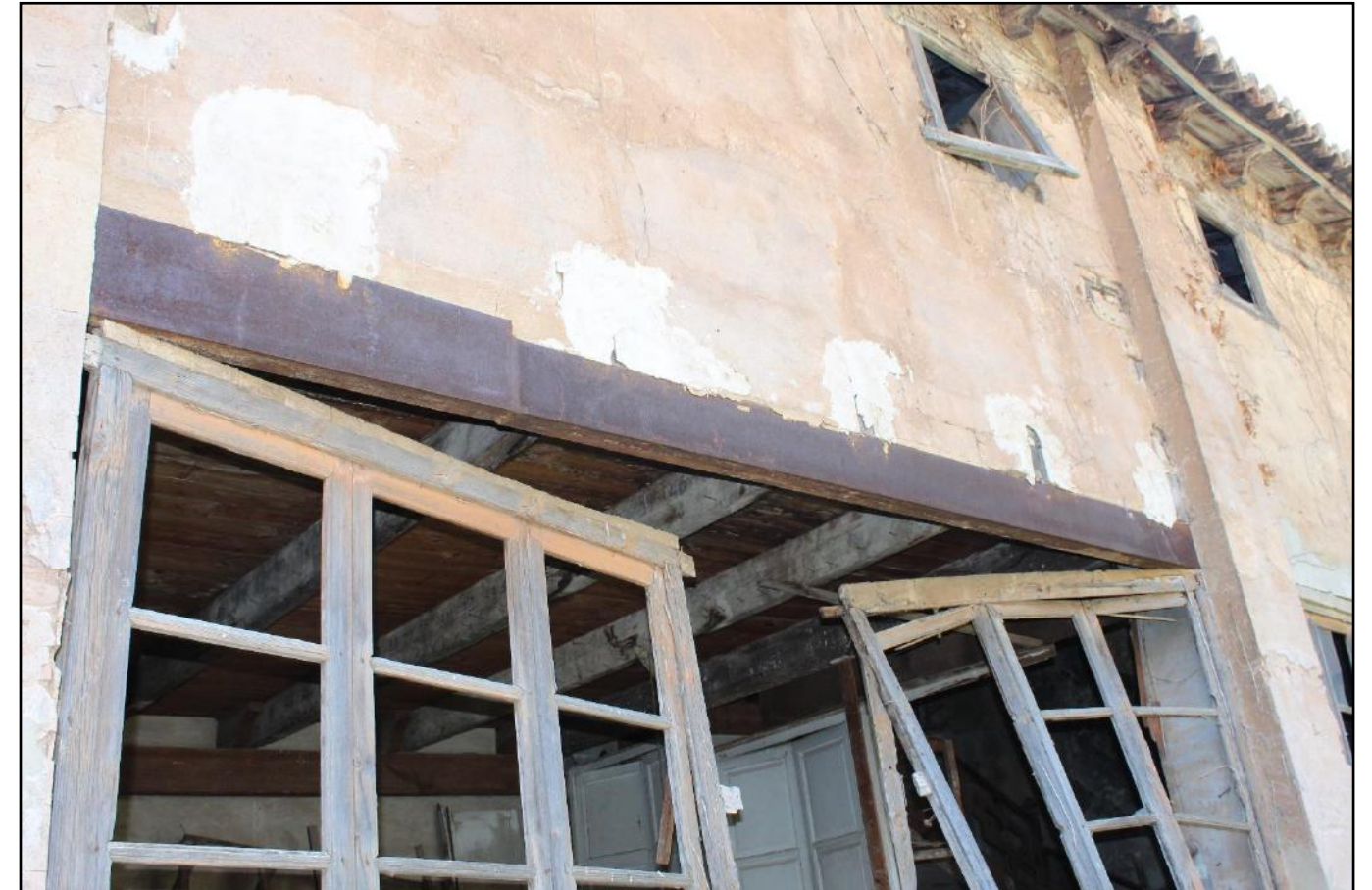
Ilustración 98 Carpintería deteriorada Fuente: Propia
