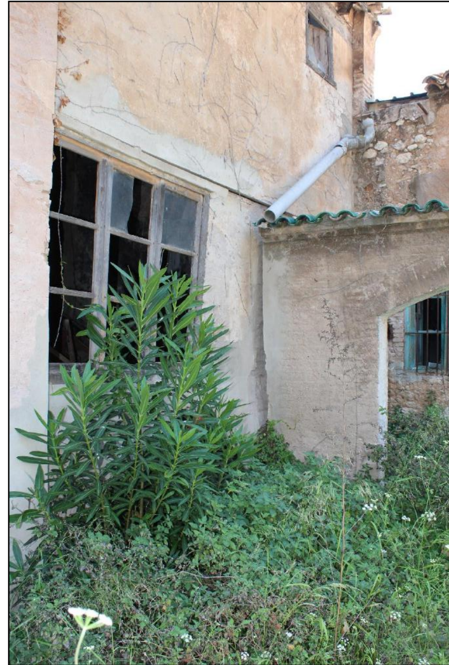
Ilustración 107 Pandeo visto desde el exterior Fuente: Propia
