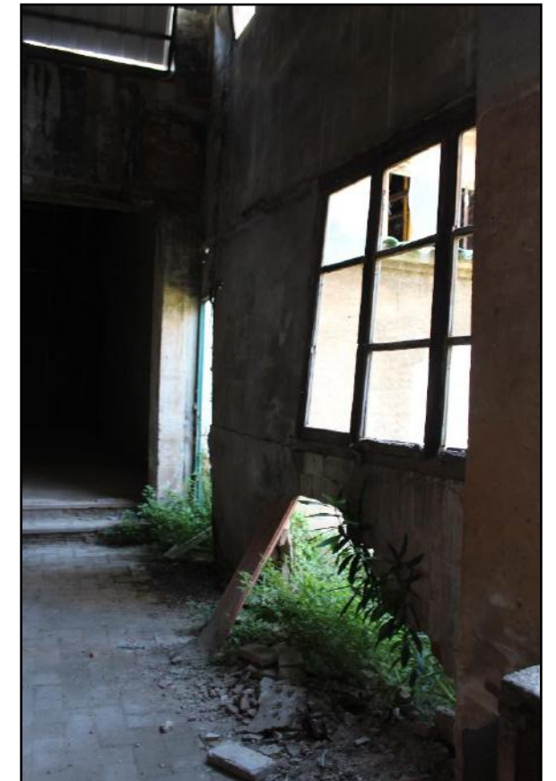
Ilustración 104 Pandeo en paramento Noroeste Fuente: Propia
