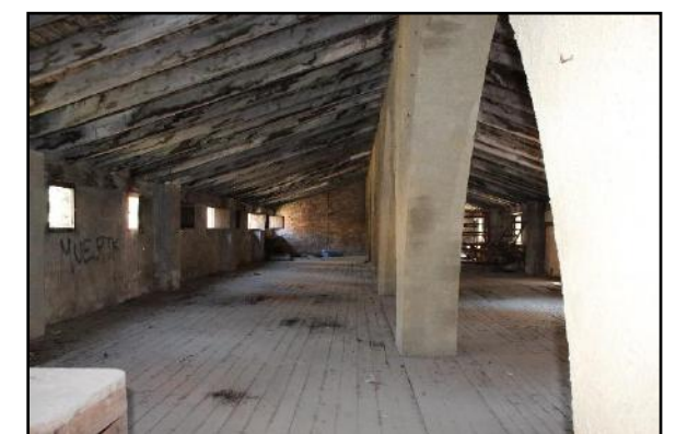
Ilustración 112 Humedad forjado P. 1ª Fuente: Propia
