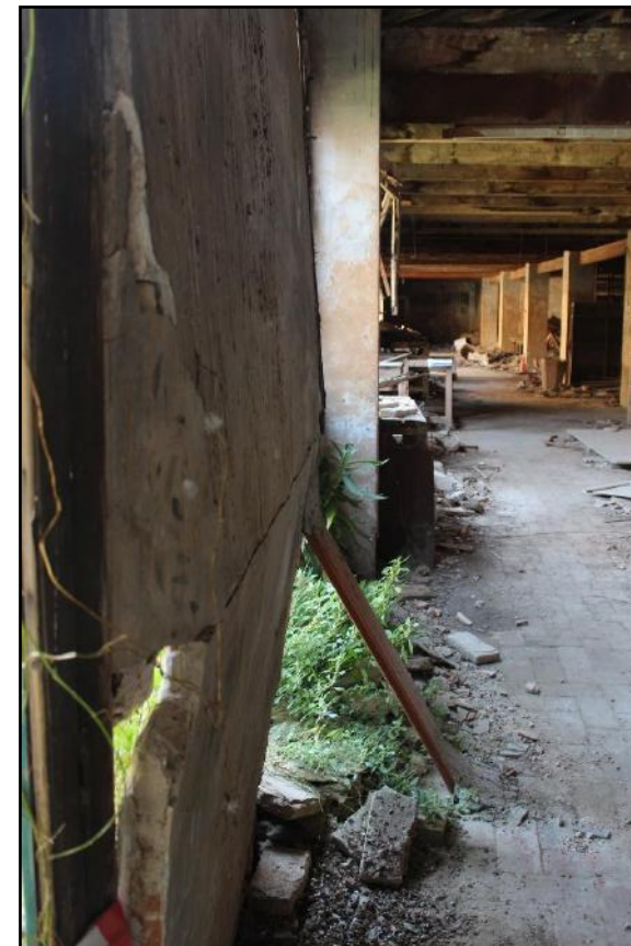
Ilustración 102 Pandeo paramento Noroeste Fuente: Propia
