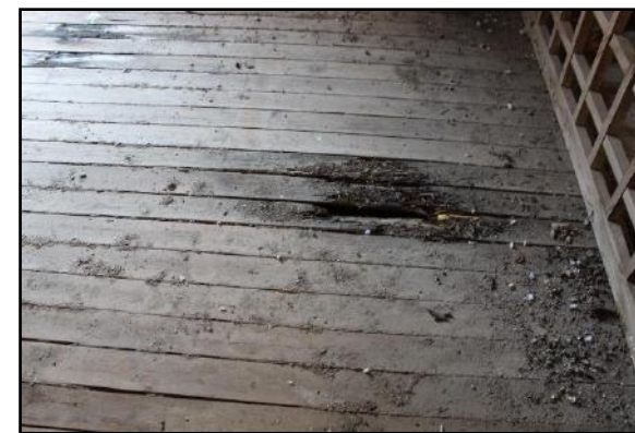
Ilustración 111 Humedad forjado P.1ª Fuente: Propia
