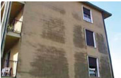
Imagen 6. Edificio con defectos en los pilares y frentes de forjado.
