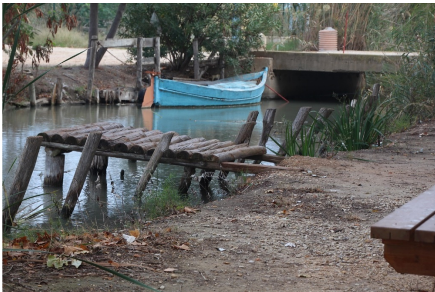
Ilustración 20: Detalle de la erosión general.
