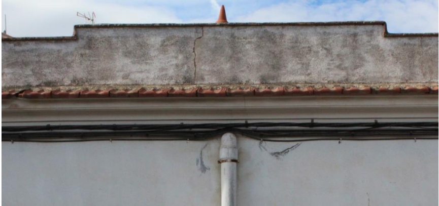
Figura 65 .Fisura peto de fábrica Fachada Noreste. Fuente propia.
