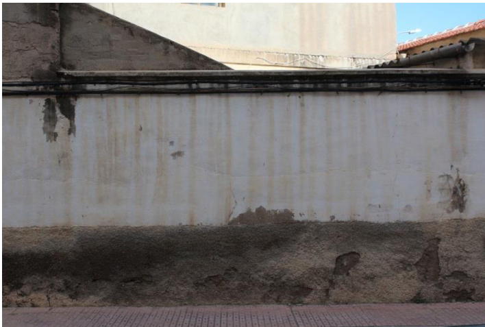
Figura 60 .Manchas de escorrentía Fachada Sur. Fuente propia.
