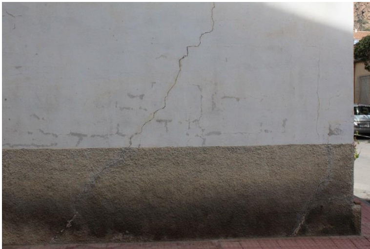
Figura 51. Grieta Fachada Sur. Fuente propia.
