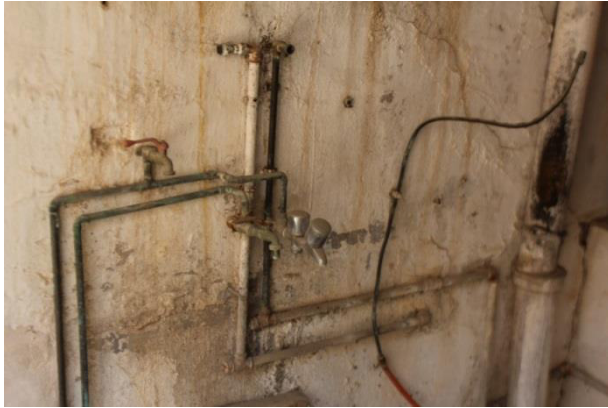
Figura 48. Instalación Fontanería Vivienda a estudio. Fuente propia.
