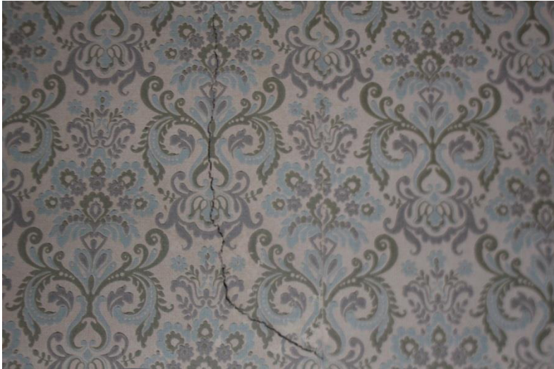
Figura 52. Grieta Fachada Sur Interior Vivienda. Fuente propia.
