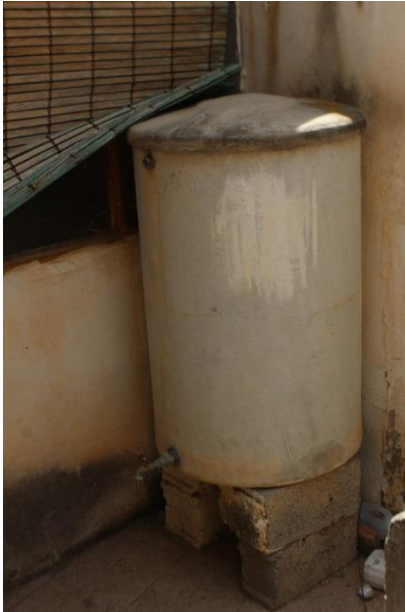
Figura 49. Instalación Fontanería Vivienda a estudio. Fuente propia.
