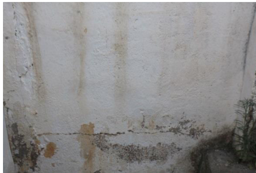
Figura 68 .Manchas de humedad Patio interior. Fuente propia.
