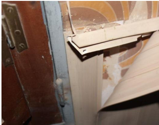
Figura 67 .Manchas de humedad interior vivienda. Fuente propia.
