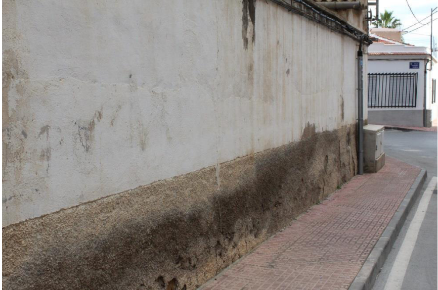
Figura 54. Manchas de humedad Fachada Sur. Fuente propia.
