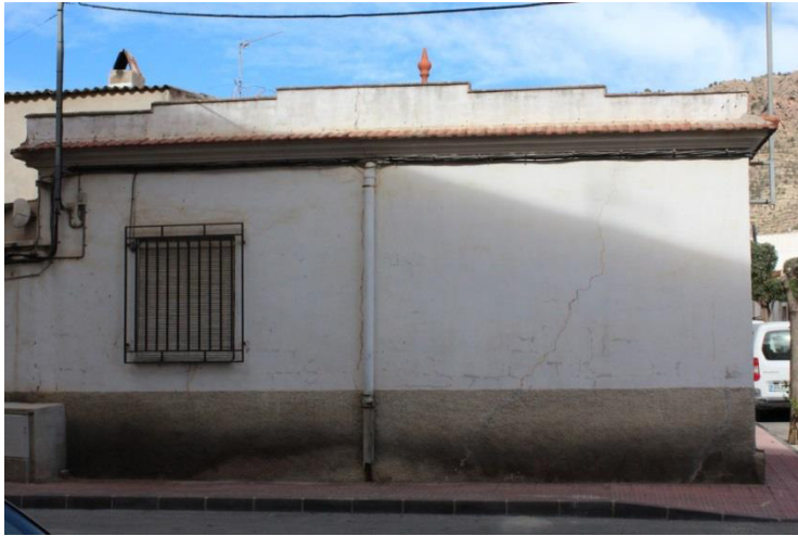
Figura 50. Grieta Fachada Sur. Fuente propia.
