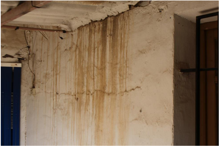
Figura 61 Manchas de escorrentía patio interior. Fuente propia.
