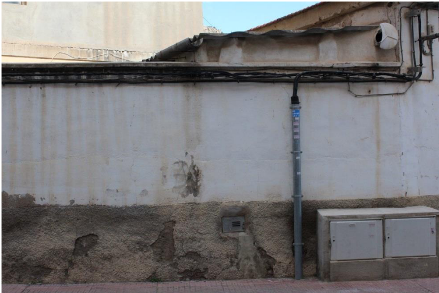
Figura 69 .Manchas de humedad fachada Sur. Fuente propia.
