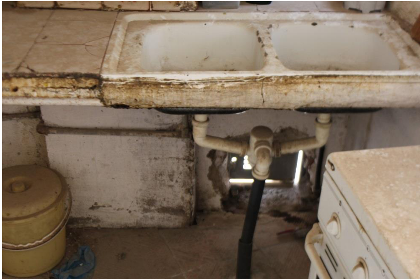
Figura 47. Instalación Fontanería Vivienda a estudio. Fuente propia.
