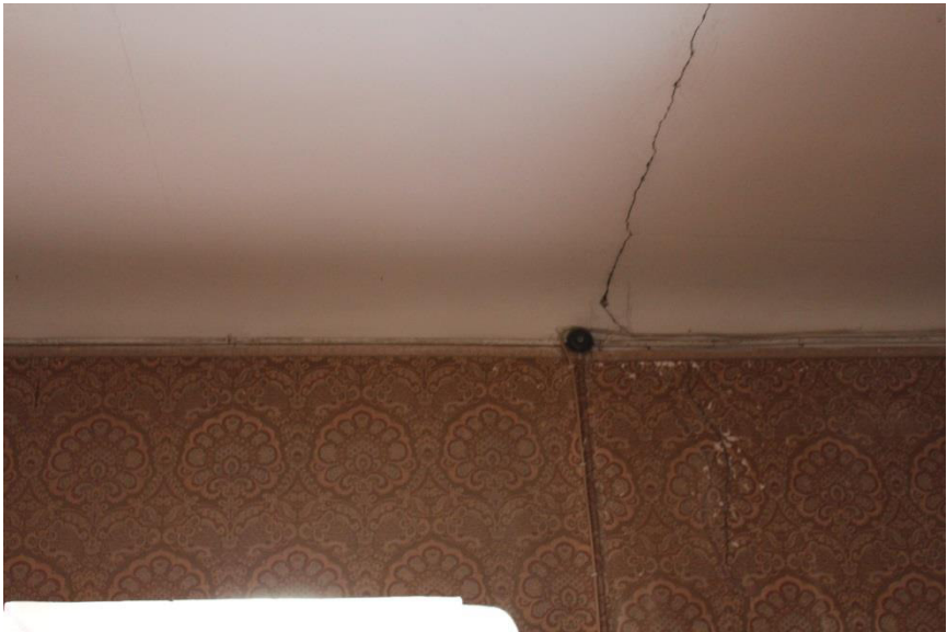
Figura 59. Fisura de retracción. Fuente propia.
