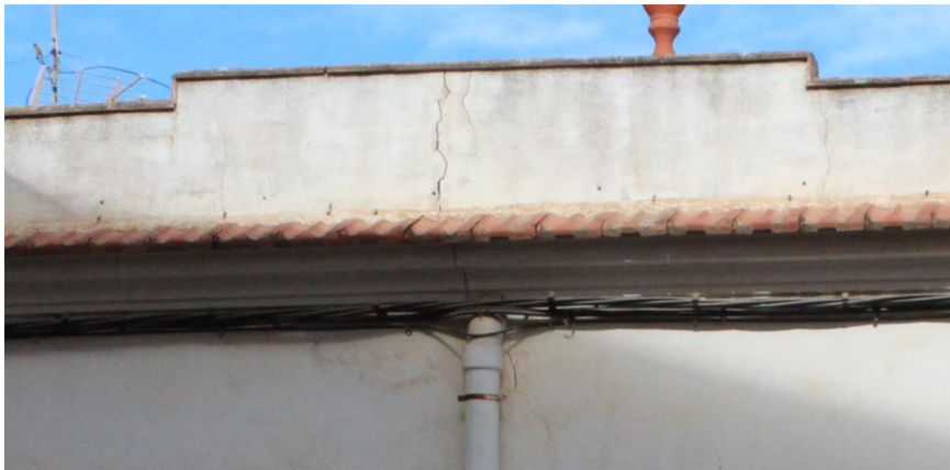
Figura 66 .Fisura peto de fábrica Fachada Sureste. Fuente propia.
