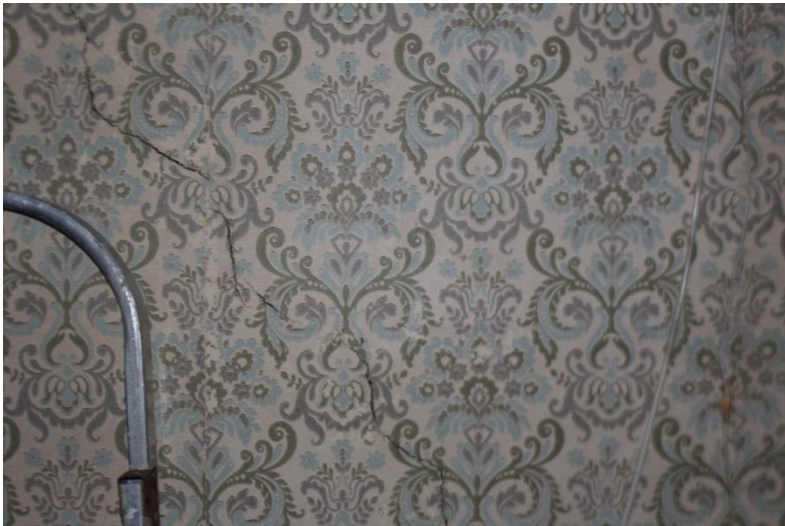
Figura 53. Grieta Fachada Sur Interior Vivienda. Fuente propia.
