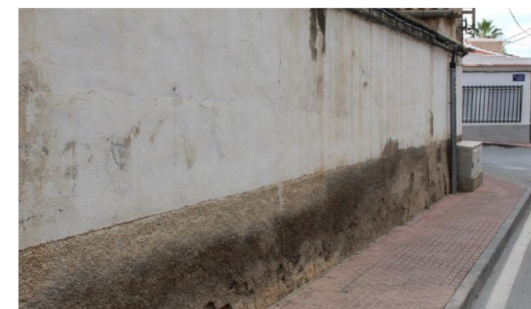
Figura 12. Manchas de humedad a distinto nivel
