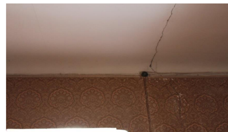
Figura 11. Fisuras de retracción en capa de compresión en forjado de viguetas
