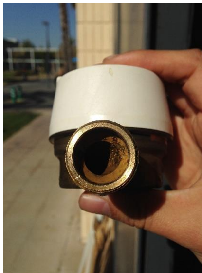
Figura 5 Deposiciones en la tobera del contador.
