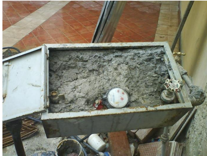
Figura 3 Instalación precaria de un contador en condiciones de servicio.
