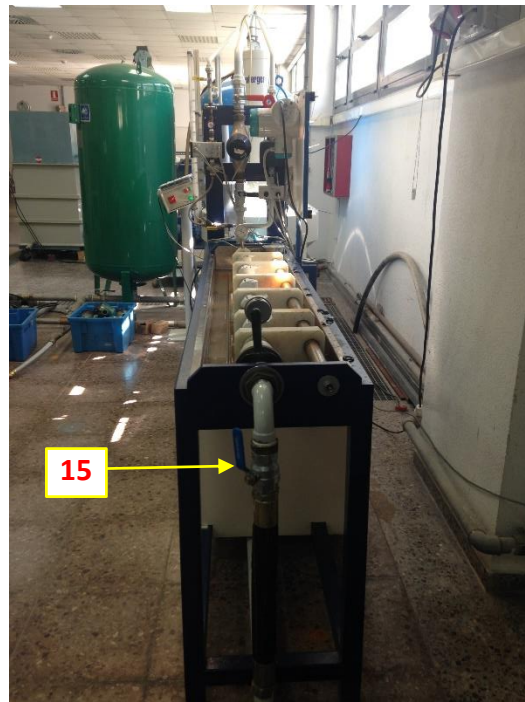
Figura 15 Válvula de accionamiento principal
