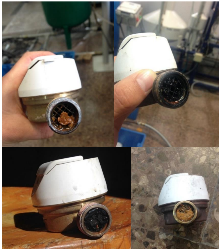
Figura 2 Obstrucción del filtro
