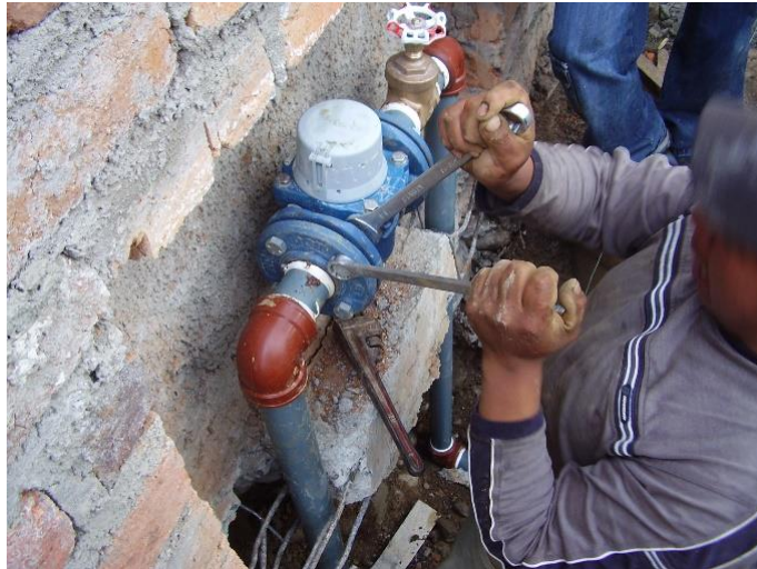
Figura 4 Instalación errónea de un contador, sin cumplir requerimientos en cuanto a longitudes mínimas.
