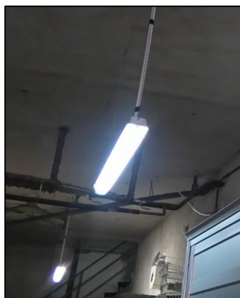
Figura 18: Tubo halógeno situado en el interior del local.
