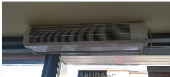
Figura 11: Aire acondicionado tipo cortina de viento.
