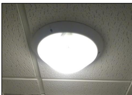
Figura 15: Iluminación tipo LED en ambos lavabos de la estación.
