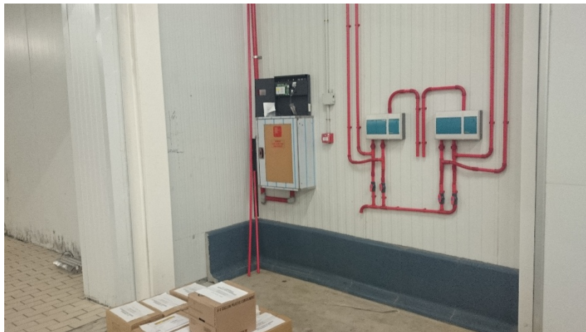
20. En esta imagen se puede ver el sistema de detección de humo por aspiración en el exterior de las cámaras donde se recogen las muestra de aire aspirado de las cámaras. Se puede apreciar también a su izquierda un pulsador de detección manual de incendios.
