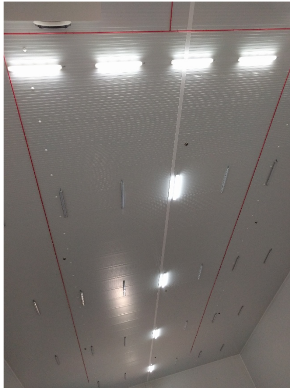
19. Tuberías del sistema de detección por aspiración en el interior de las cámaras de congelados
