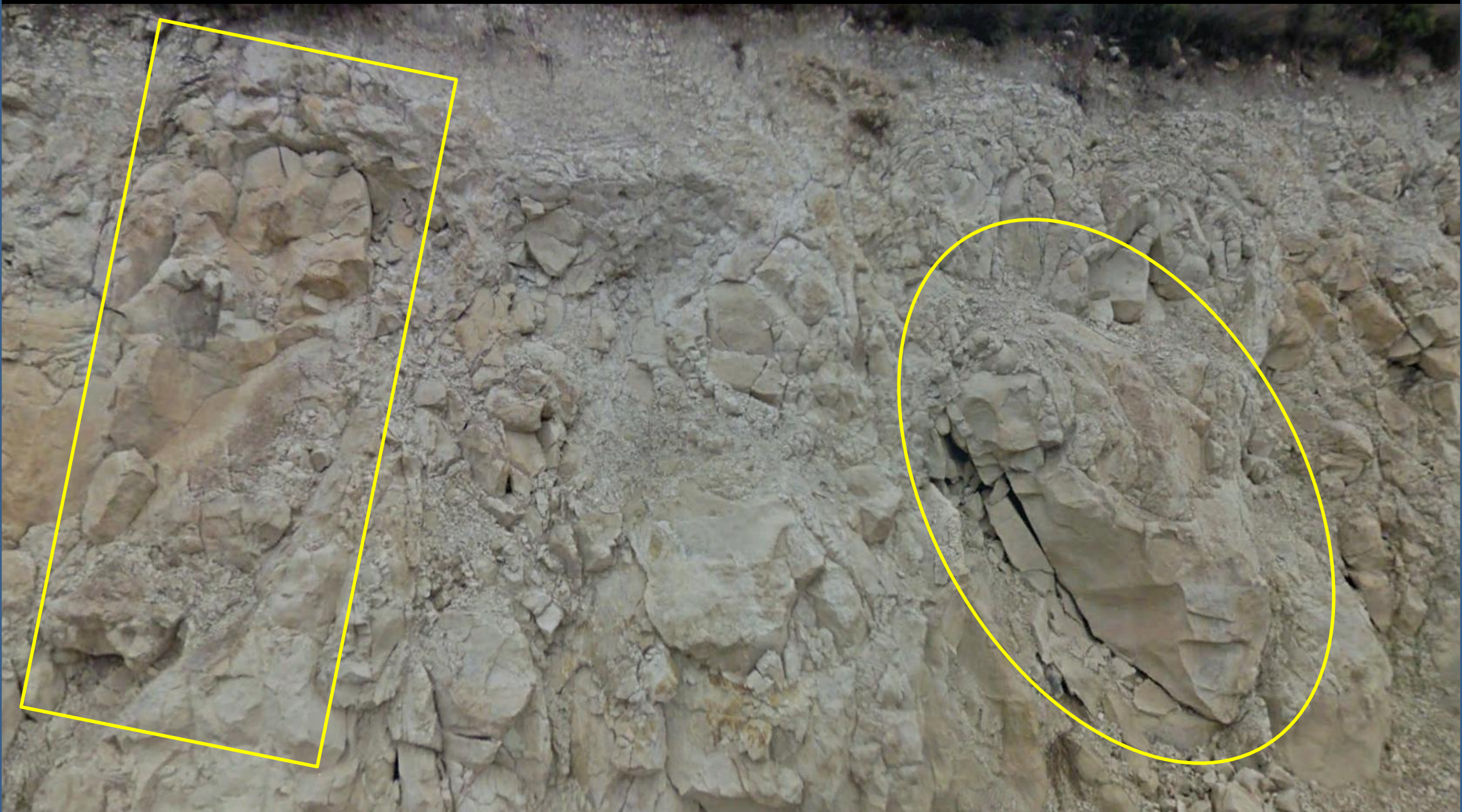
Meta-estabilidad del talud de margas del Burdigaliense-Langhiense, Mioceno Med. Terciario. NE de Onil, Alicante. NE Hoja de Castalla.
