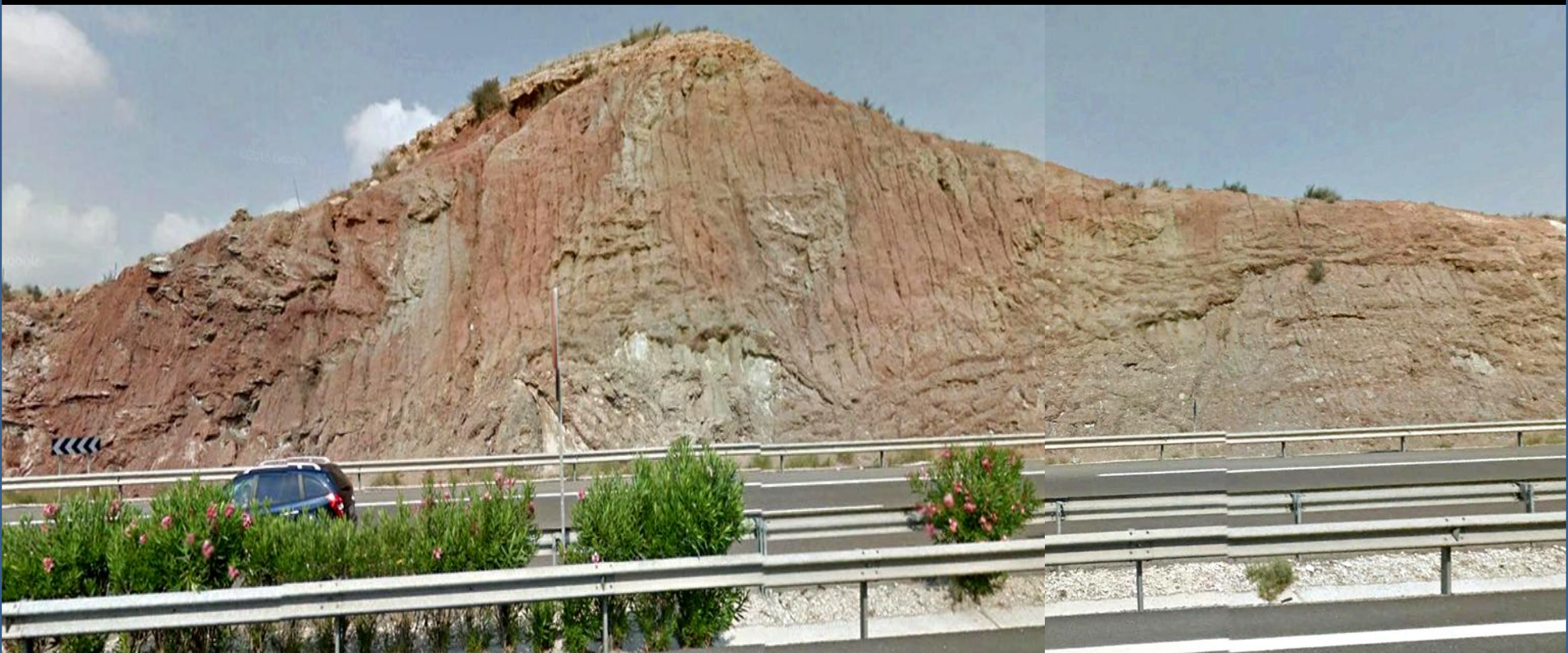
Talud de arcillas y yesos del Keuper, Triásico Sup. NW de Novelda, Alicante. Centro W Hoja de Elda.
