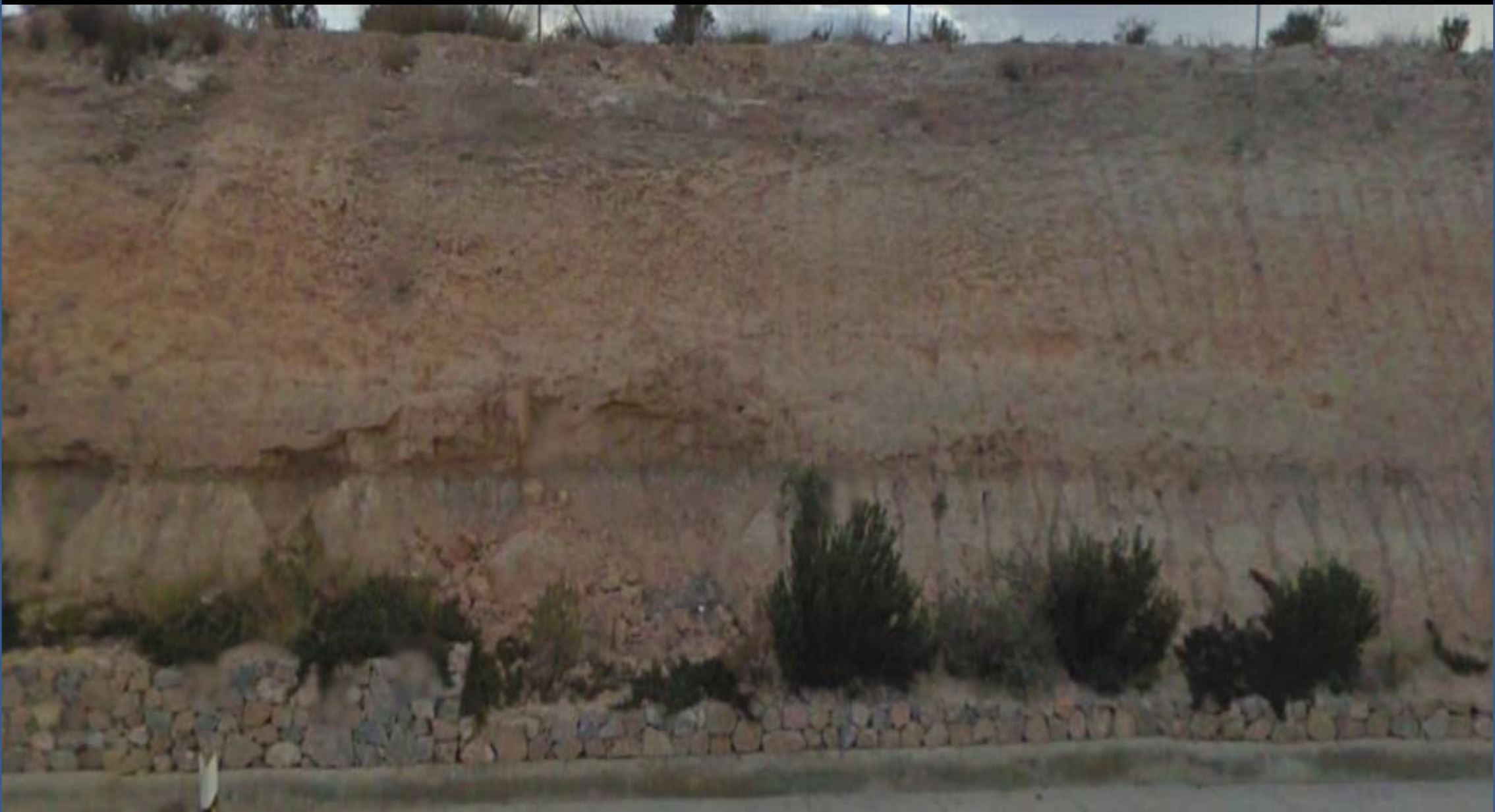
Desprendimiento en talud de limos y arenas algo encostradas a techo. E de Sierra del Molar, Alicante. Centro N Hoja de Guardamar del Segura
