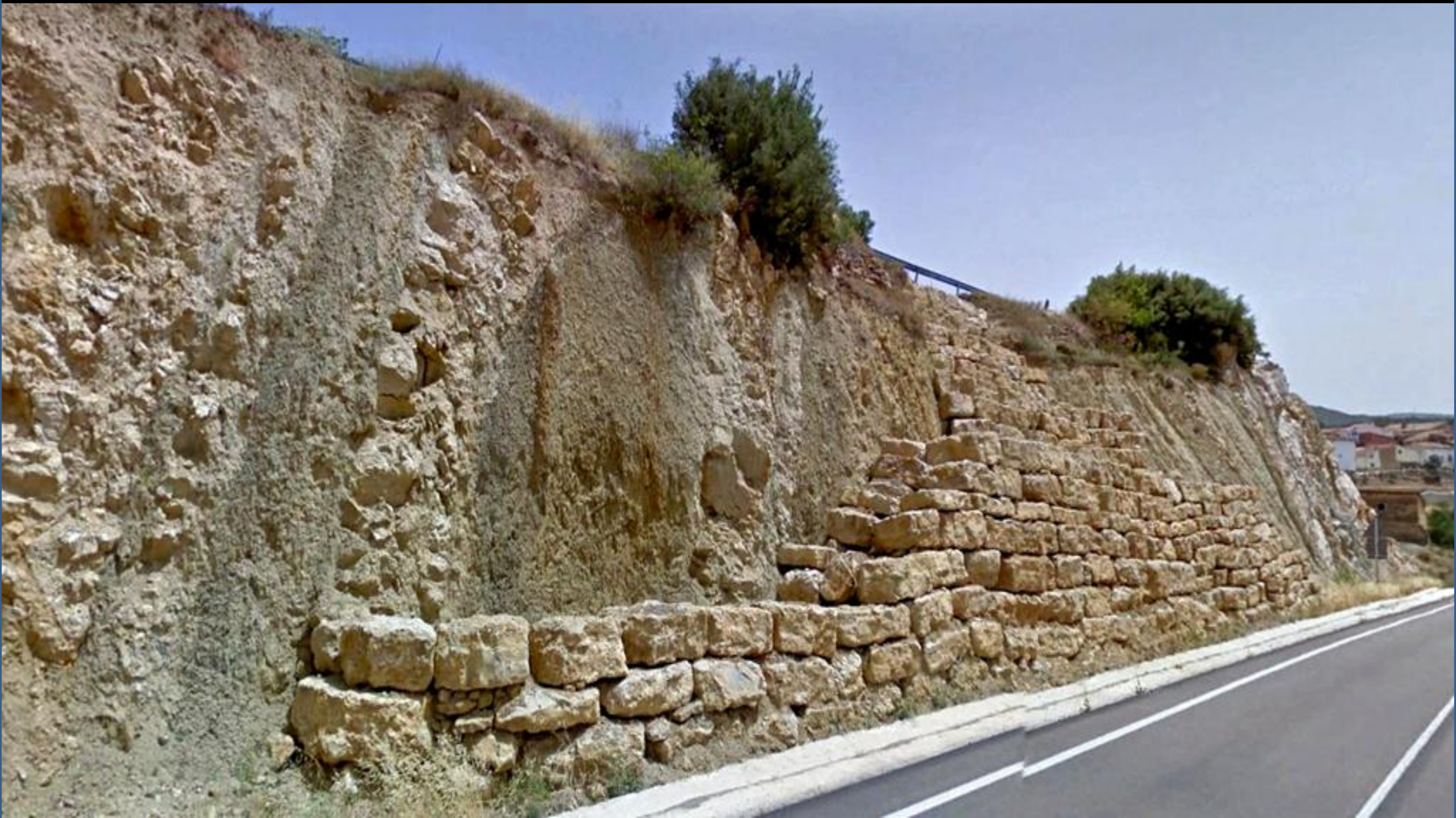
Actuación para estabilizar el talud de areniscas y calizas arenosas subverticales, del Cretácico Inf. N de Ortells, Castellón. SW Hoja de Peñarroya de Tastavins
