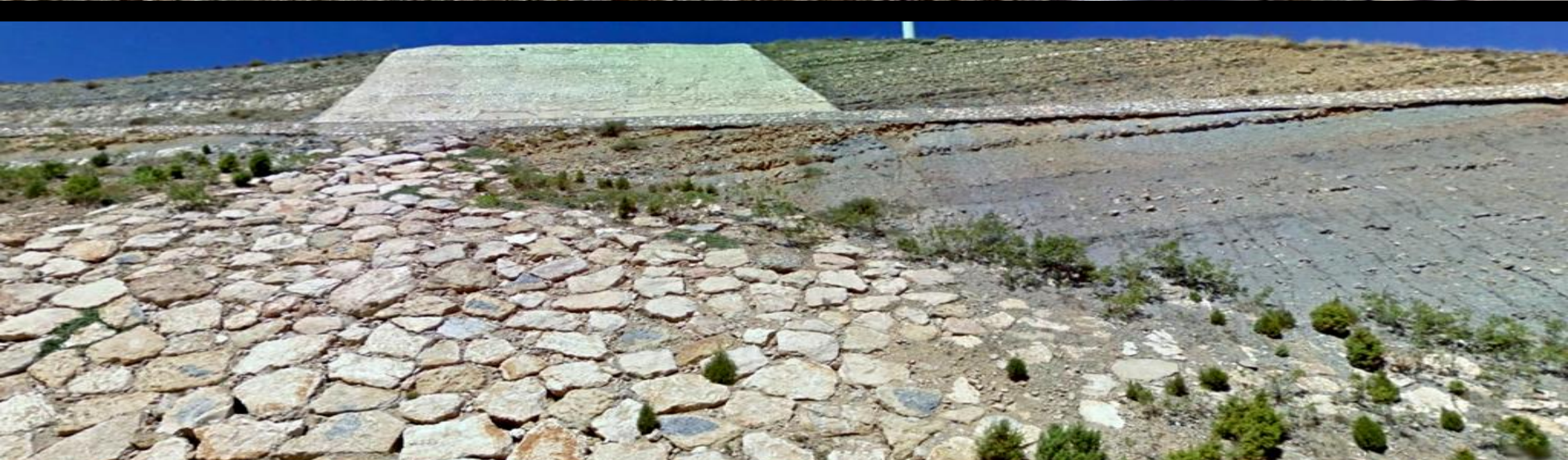
Actuaciones para la estabilización de taludes. En las calizas, margas y areniscas del Barremiense, Cretácico Inf. cerca del Barranco de Gerona. NW NW del Caserío de Torre Miró. Centro S Hoja de Peñarroya de Tastavins
