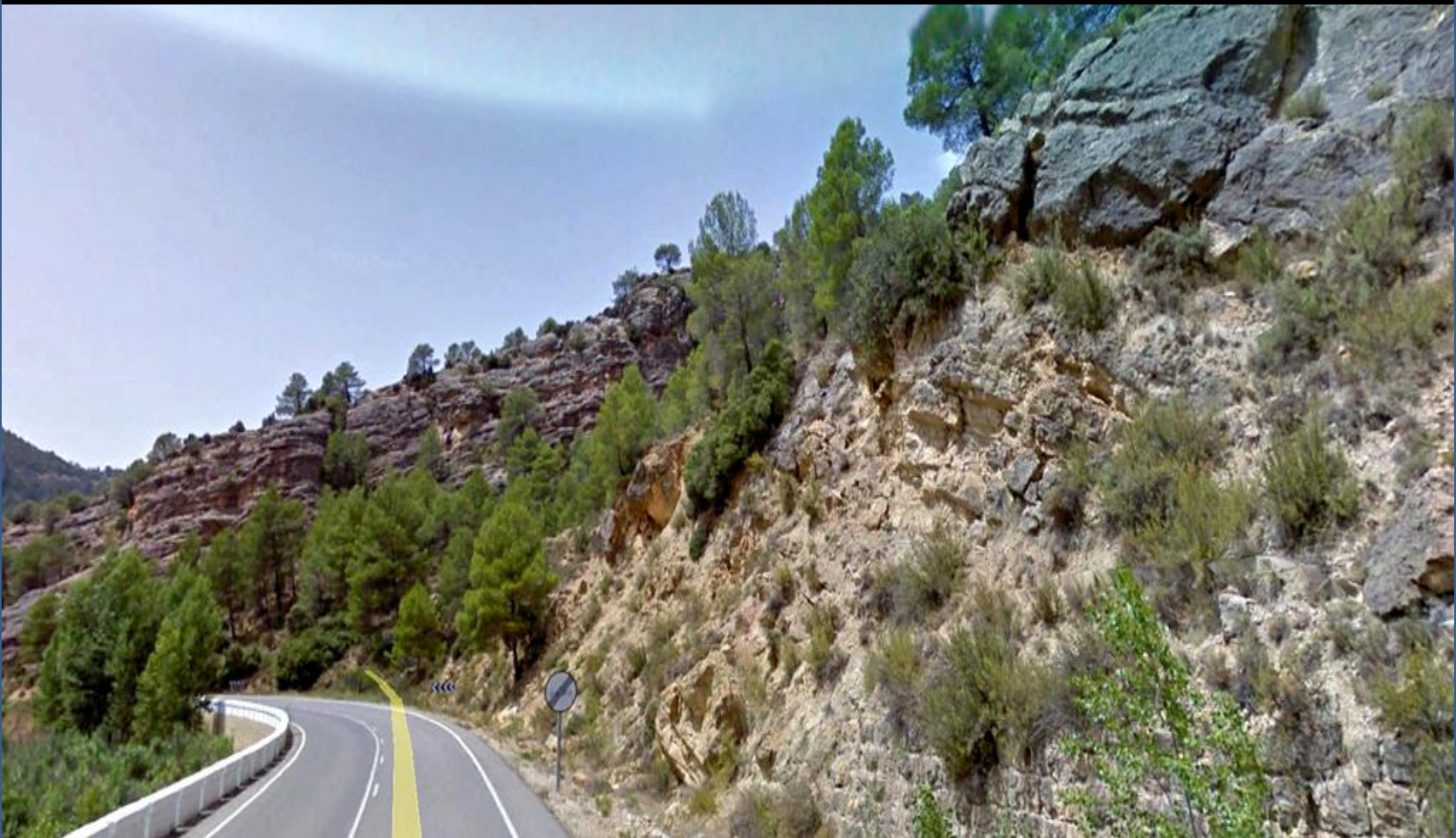
Peligrosidad en carretera- desprendimientos en las calizas del Cretácico Inf. N de Zorita del Maestrazgo. En el Barranco del Río Bergantes. Castellón. W Hoja de Peñarroya de Tastavins.
