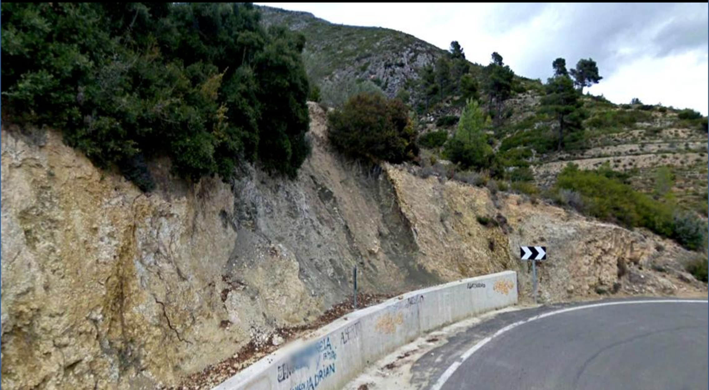
Inestabilidad de ladera en las areniscas y margas arenosas del talud en El Terciario al W de Ayelo de Malferit. E Hoja de Canals
