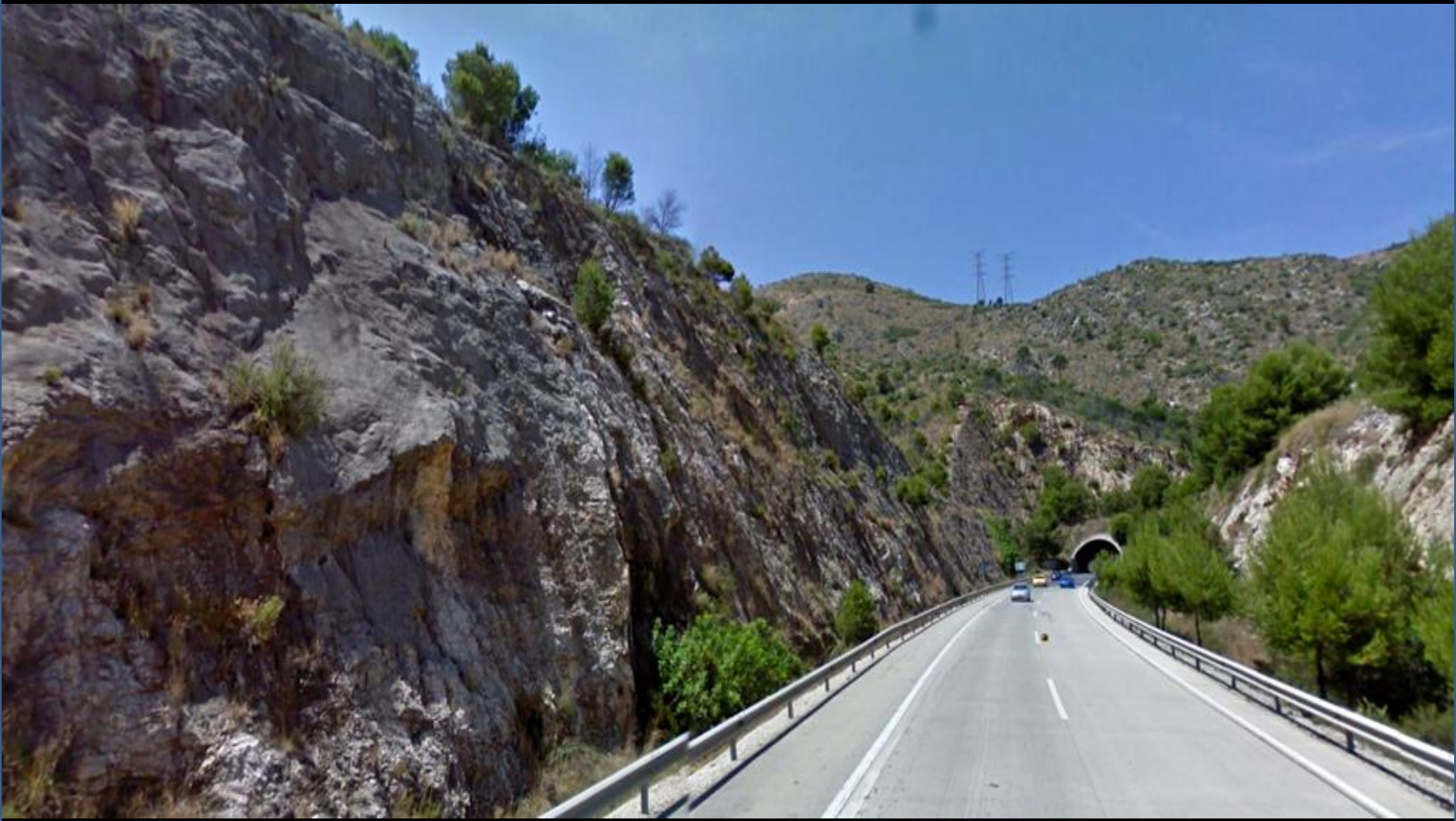
Salida S del Túnel de la Autopista del Mediterraneo, en calizas y dolomías del Cretácico Sup., y glacis Cuaternario. Al S de Xeresa, NW de Beniopa. NE Hoja de Játiva.
