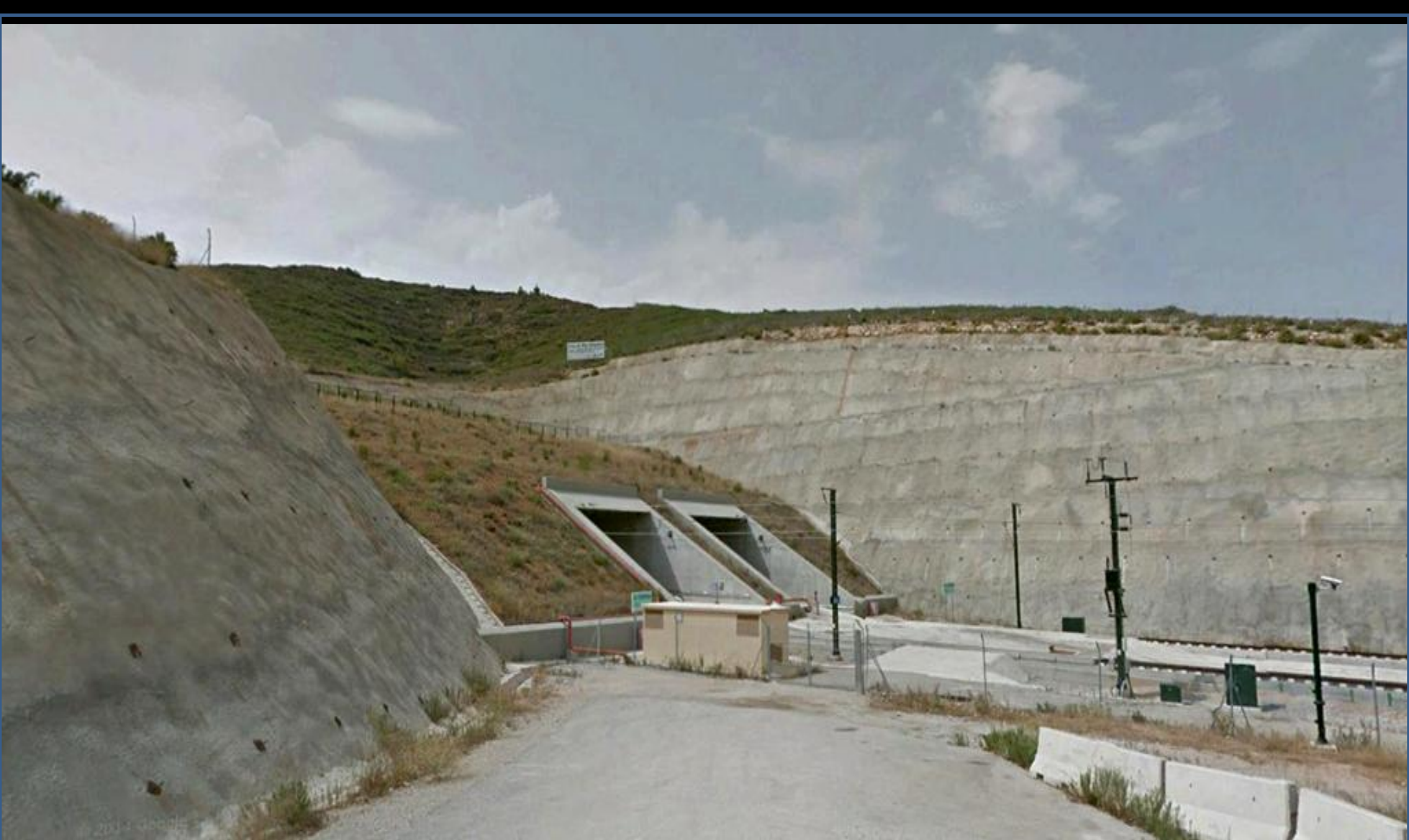
Bulonado y gunitado sobre los taludes del ferrocarril al N de Buñol, NE de Alto Gordo, Valencia. Jurásicos Inf.
