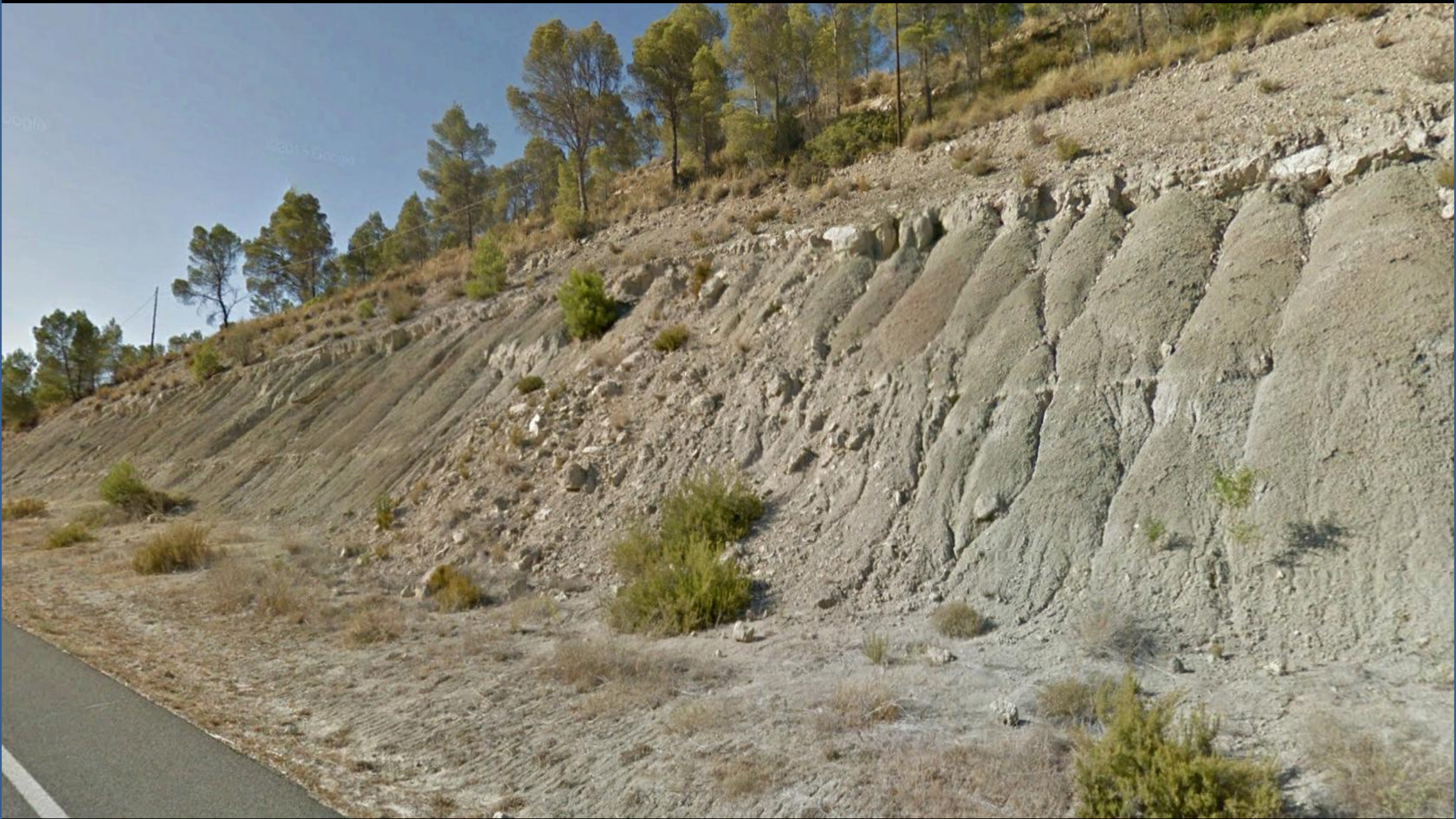
Talud meta-estable de margas arcillosas y areniscas del Mioceno Inf. Terciario. N del Balneario de Fuente Podrida, Valencia. SW Hoja de Venta del Moro.
