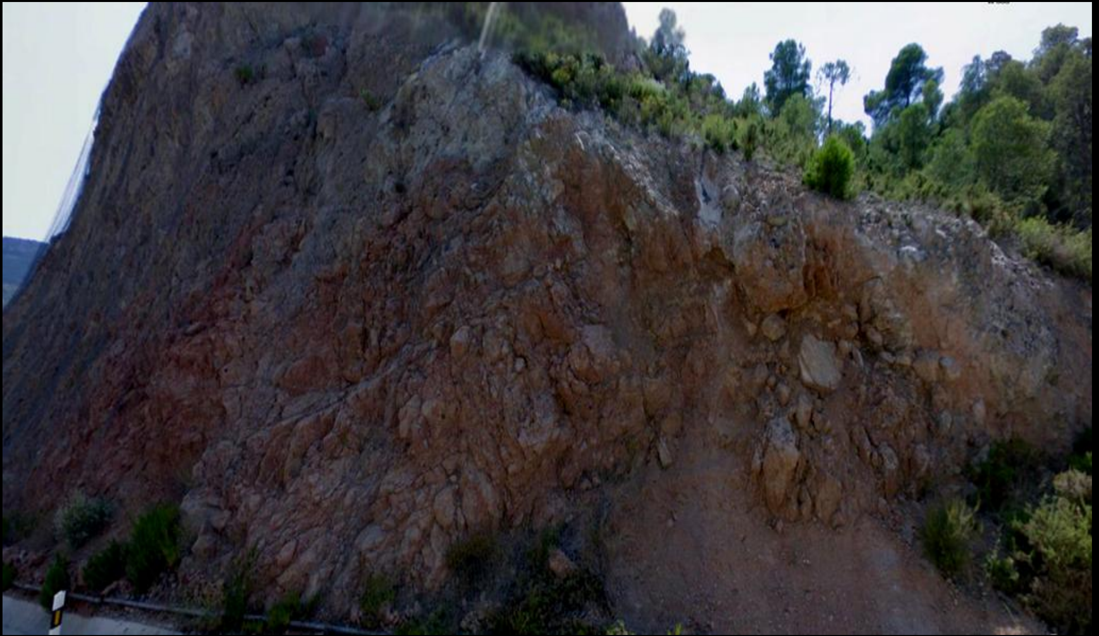
Mallazo de protección sobre dolomías- carniolas- muy brechificadas del Triásico Sup. N de Cofrentes. Centro W Hoja de Jalance
