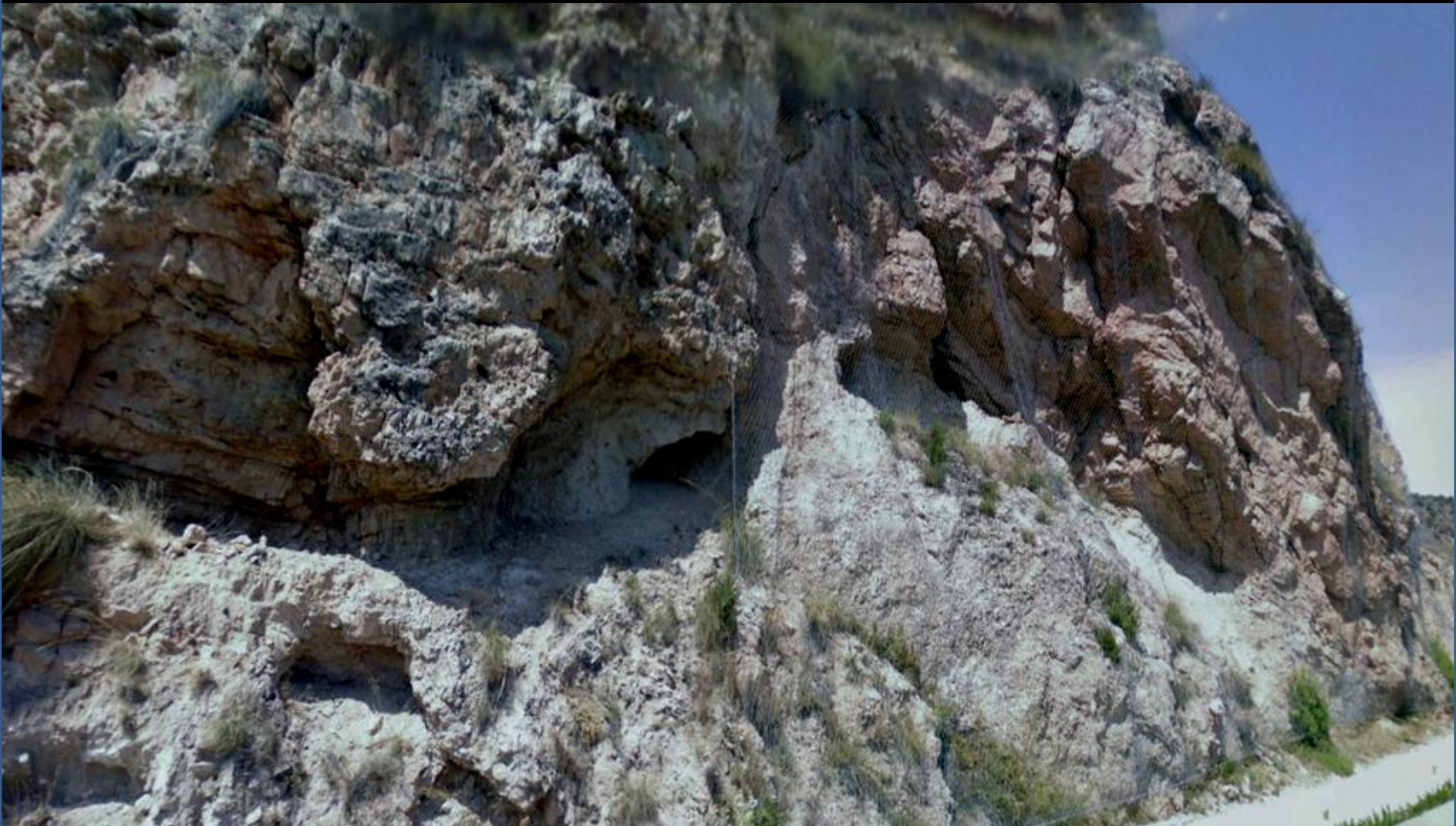
Protección- mallazo- en las canchales sobre las arcillas del Keuper, Triásico. Al N de Cofrentes. Centro W Hoja de Jalance
