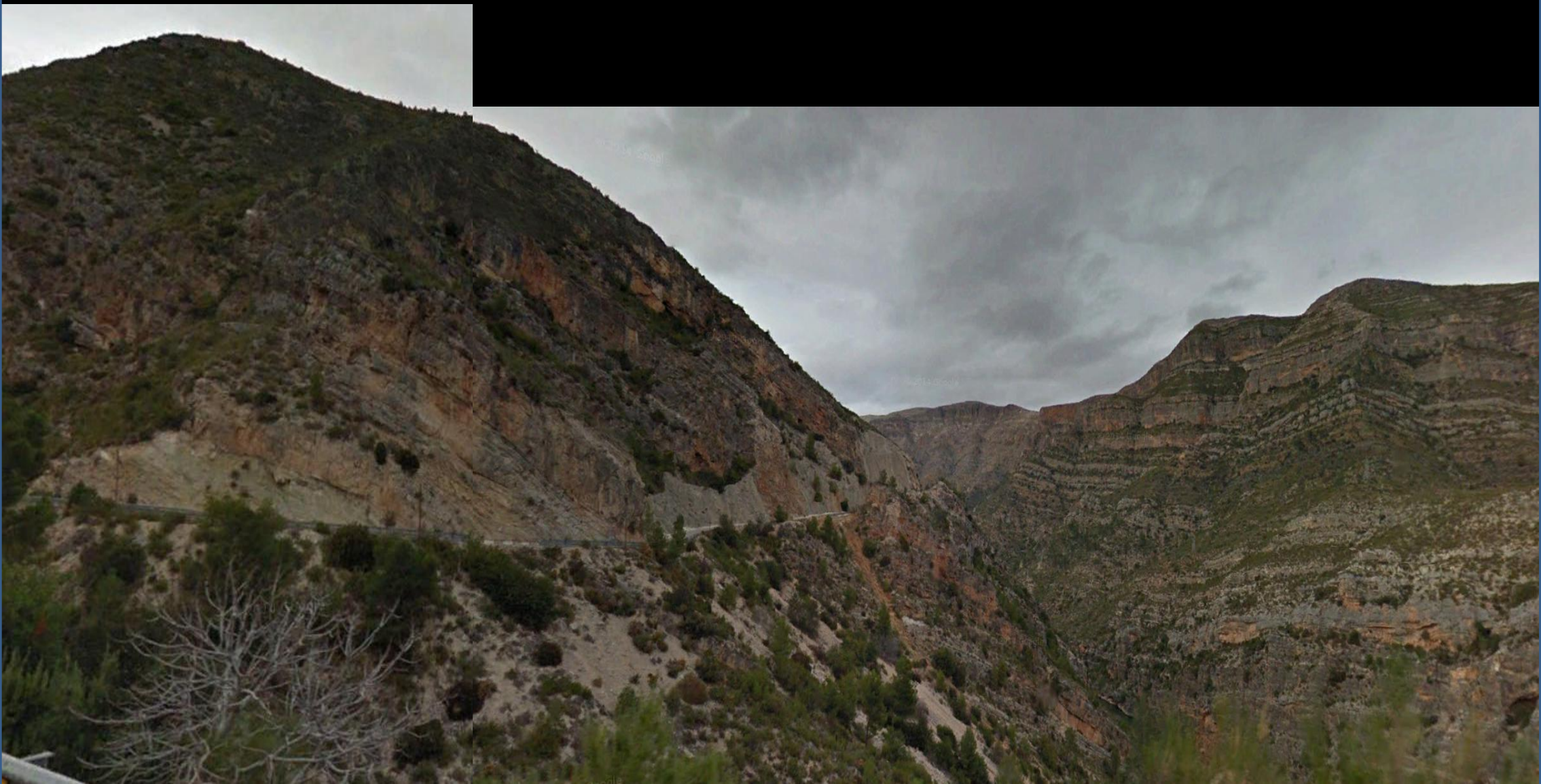
Carretera a Millares desde Dos Aguas, Valencia. W Hoja de Llombay. Desde las calizas del Cretácico Sup. A las del Cenomaniense, Cretácico Sup. Gunitado de tramos margosos.
