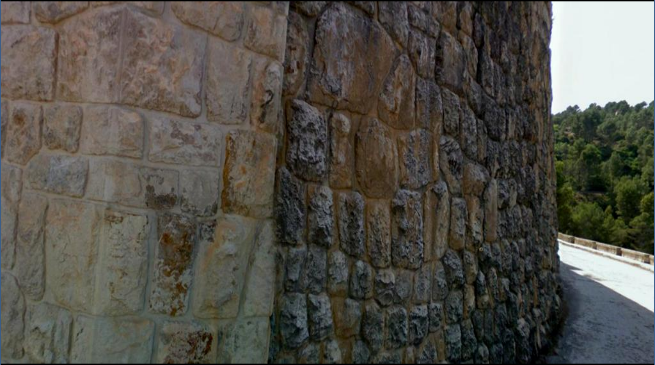
Detalle de labra en los revestimientos, con bloques de calizas del Jurásico, en la Presa de Benageber, Valencia. SW Hoja de Chelva.
