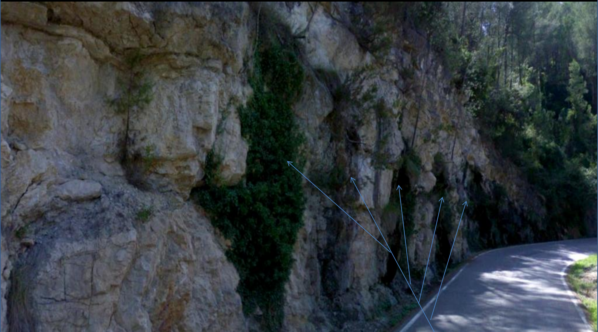
Calizas arcillosas del Dogger, Jurásico Med. y surgencias de agua en el talud. Zona W Embalse de Benageber, Valencia. SW Hoja de Chelva
