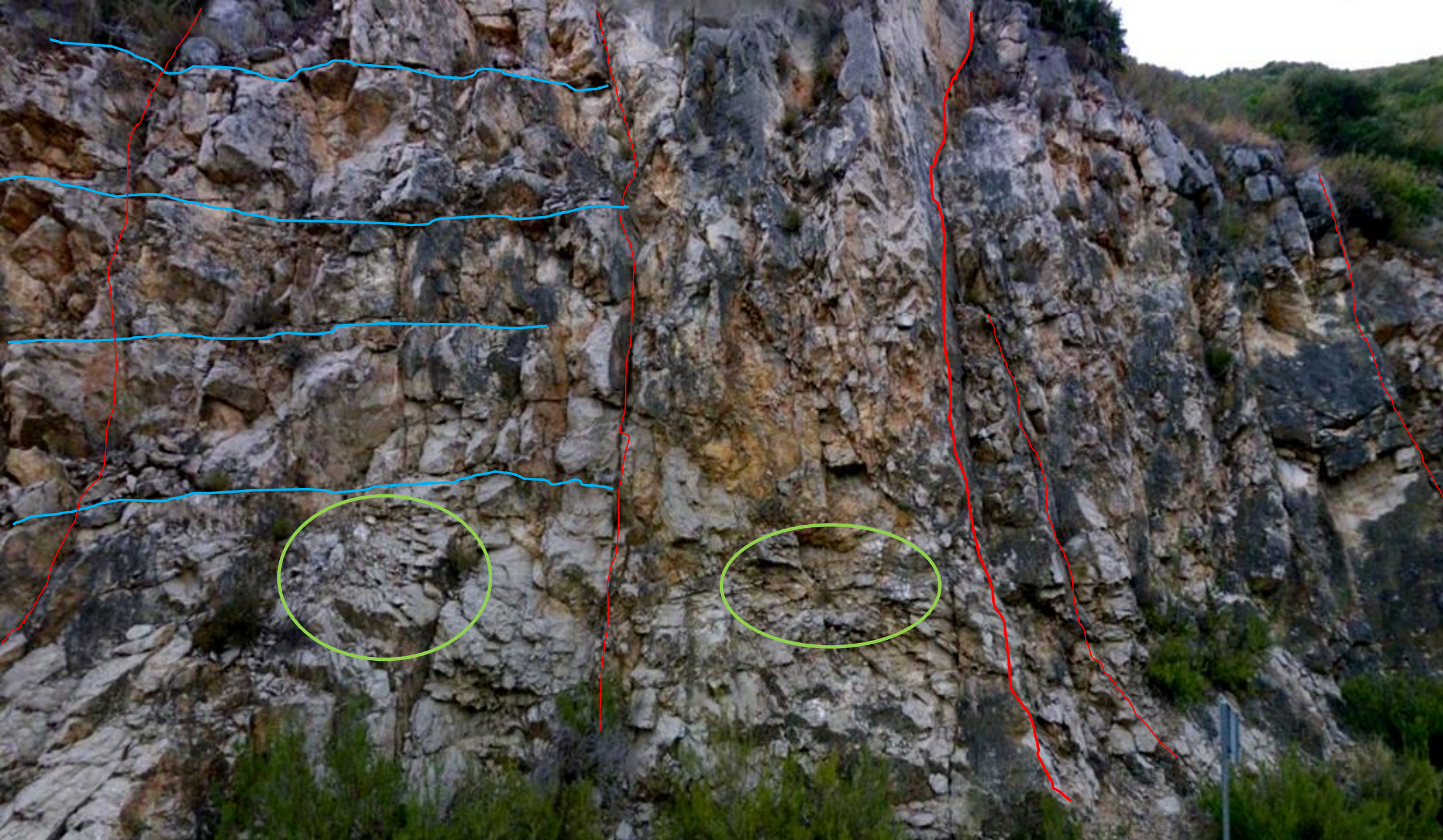
Familias de discontinuidades- por fallas, estratificación, diaclasado..- en las calizas pisolíticas del Kimmeridgiense, Malm, Jurásico. En lo de amarillo efectos de los barrenos al ampliar la carretera. Al SW del Alto de La Bandera, hacia Sot de Chera . NE Hoja de Chulilla
