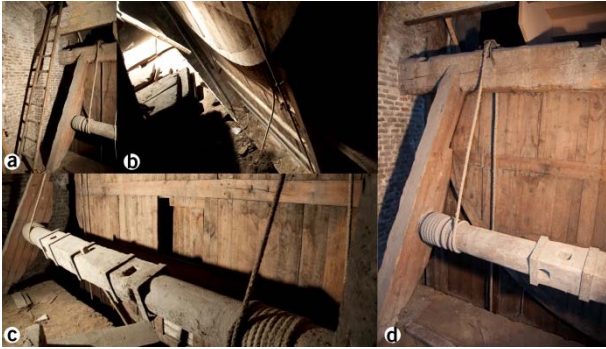
Figura 6: a) Escalera de acceso al sótano de la capilla del Monumento. b) Vista interior del foso en la que se distinguen las dos cuerdas y la parte semicircular plegada sobre la rectangular. c) Mecanismo de elevación del telón por medio de un torno simple. d) Torno, soga y polea del mecanismo. Soporte del telón plegado.
