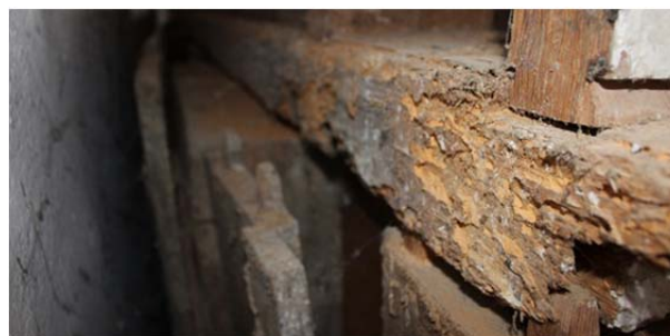
Figura 4: Detalle de alteraciones localizadas en el conjunto: ataque de xilófagos.
