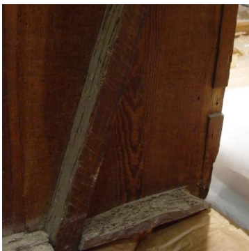
Fig. 34. Detalle del ataque del daño causado por los insectos xilófagos en uno de los travesaños.
