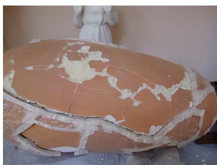
Fig. 21 y 22, proceso de la eliminación de estuco débil y saneamiento de las grietas.
